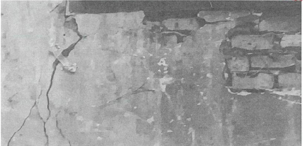
18 Elewacja oficyny – widoczne szkietko, założone w celu stwierdzenia stabilności spękań – niestety z dokumentacji przeanalizowanej w WUOZ nie wynika, kiedy te badania robiono – najprawdopodobniej w latach 90 – tych lub na początku 2000. Fakt, że pasek szkła nie pękł sugeruje, że pęknięcia są stabilne, nie mają tendencji do pogłębiania się.
