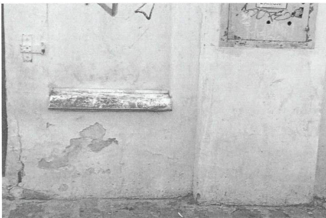
11i 12. Zniszczenia tynków są najsilniej widoczne w partiach zawilgoconych na skutek nieszczelności systemu odprowadzania wody, oraz w pasie przyziemia, gdzie elewacja ulega ochlapywaniu wodą i błotem pośniegowym z chodnika.
