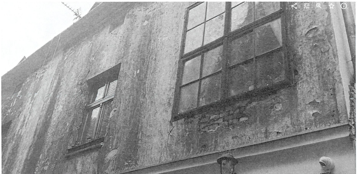
19 Elewacja oficyny w poziomie piętra. Widoczne zdestruowane tynki z licznymi ubytkami, spęcherzeniami i odspojeniami, niestarannie uzupełnione tynki przy oknach oraz ogólne zabrudzenie powierzchni i pozostałości bluszczu w postaci przyczepów.
