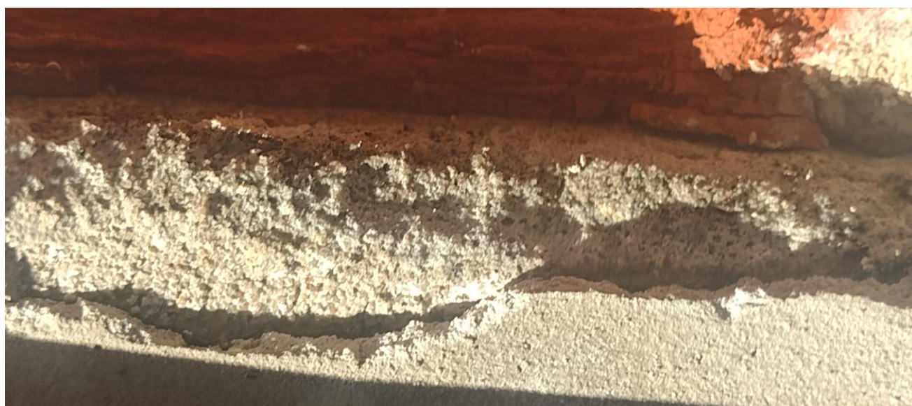
DETAL ZNISZCZONEJ WYPRAWY TYNKOWEJ NA COKOLE – ŚCIANA WSCHODNIA
