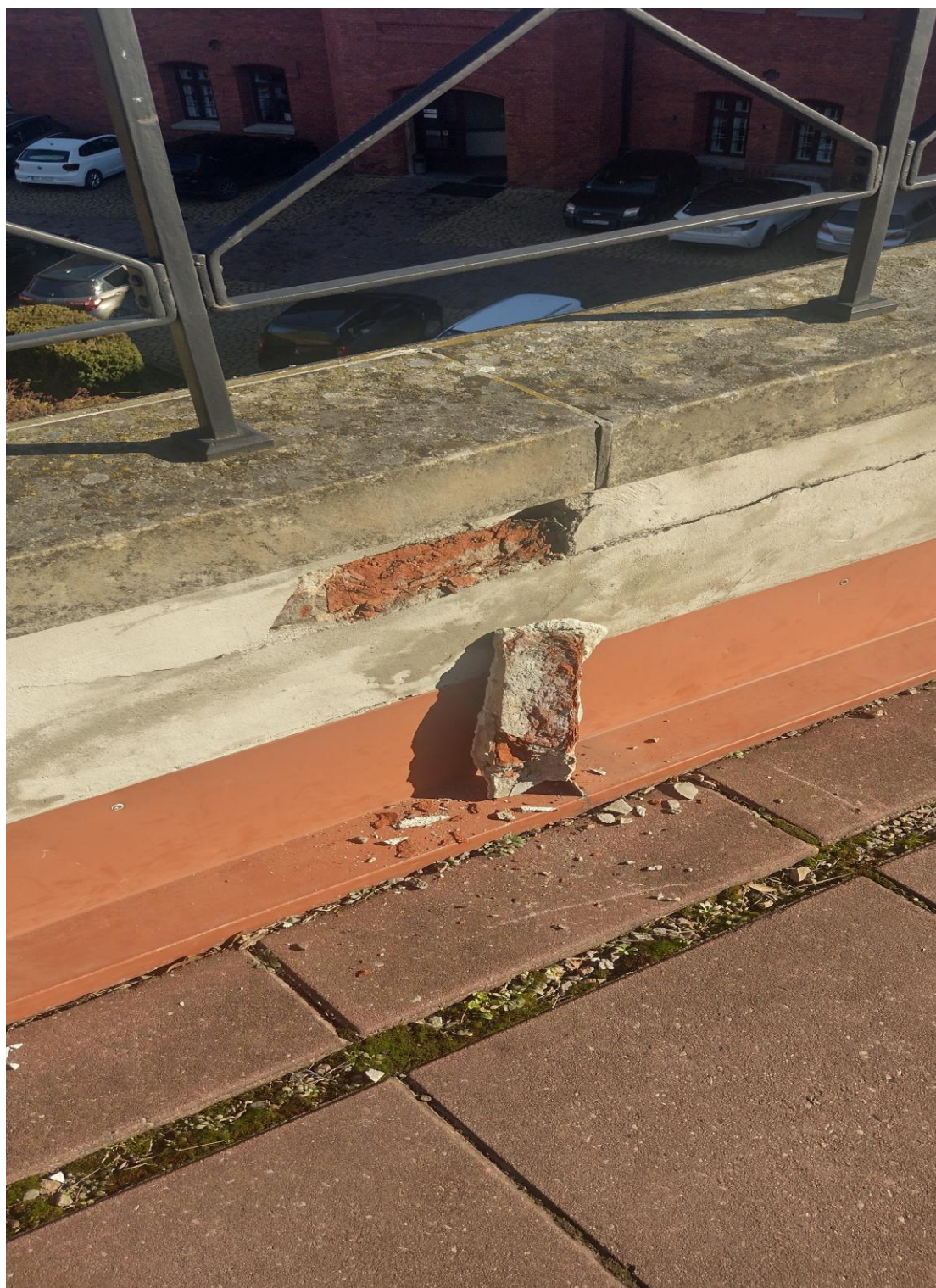
DETAL TARASU – ŚCIANA WSCHODNIA ,WRAZ Z NAKRYWĄ I BALUSTRADĄ, DESTRUKCJA MATERIAŁOWA 10.2022
