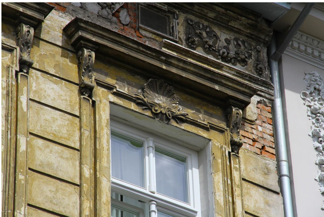
Fot.14 kamienica mieszkalna przy ul. michałowskiego 7 w Krakowie. Głębokie ubytki warstwy tynkowej w prawym narożniku elewacji, na poziomie drugiego piętra.
