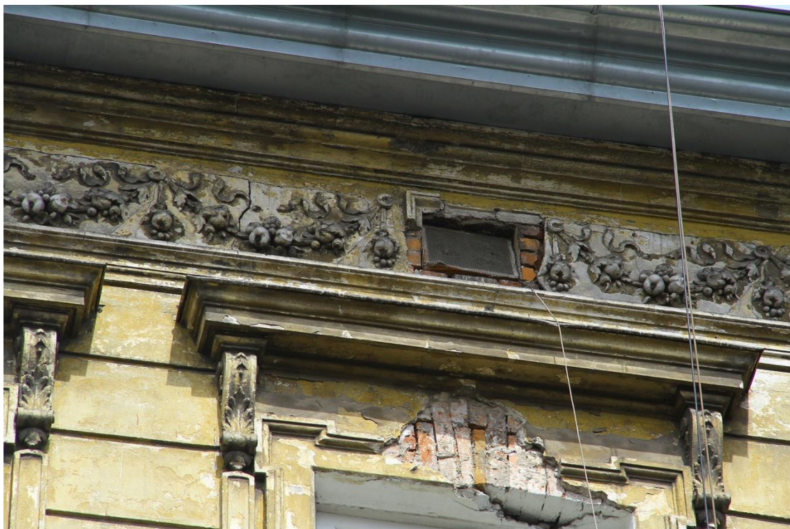
Fot.9 kamienica mieszkalna przy ul. Michałowskiego 7 w Krakowie. Ścianka kolankowa – fragment i ubytek dekoracji w nadprożu okna czwartej osi na poziomie drugiego piętra.
