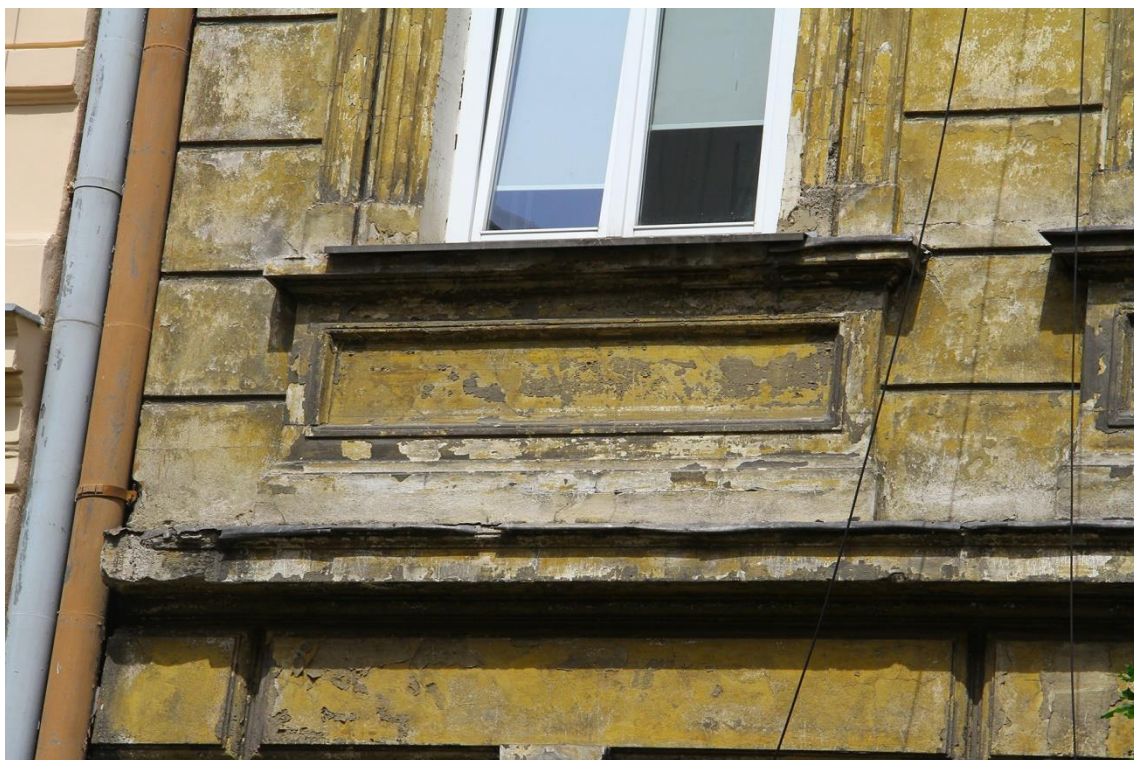
Fot.20 kamienica mieszkalna przy ul. Michałowskiego 7 w Krakowie. Gzyms kordonowy parteru, z widocznym bardzo złym stanem obróbki blacharskiej i naruszoną strukturą warstwy tynkowej na nim i powyżej.
