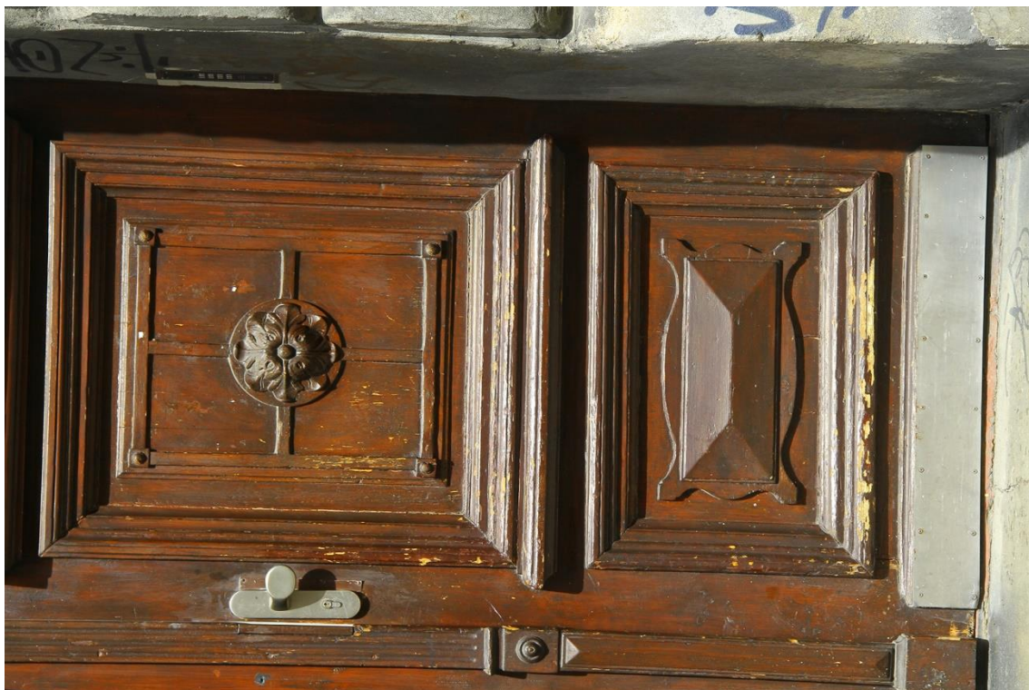
Fot.30 kamienica mieszkalna przy ul. michałowskiego 7 w Krakowie. Brama wejściowa – fragment z widocznymi drobnymi uszkodzeniami i wtórnymi elementami z aluminium.
