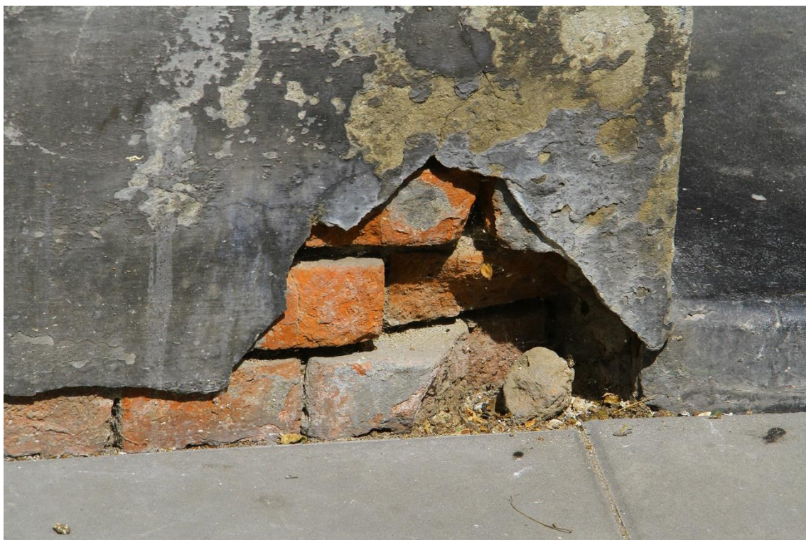
Fot.25 kamienica mieszkalna przy ul. michałowskiego 7 w Krakowie. Ubytek wstępu ceglany w dolnej partii cokołu.
