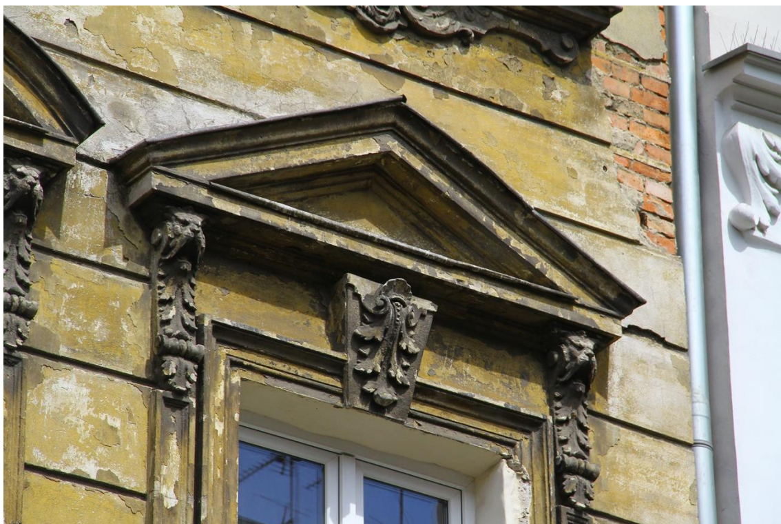
Fot.19 kamienica mieszkalna przy ul. Michałowskiego 7 w Krakowie. Dolna część dużego ubytku tynku na prawej krawędzi elewacji i wyraźne odspojenia i płytkie ubytki na boniowaniu.
