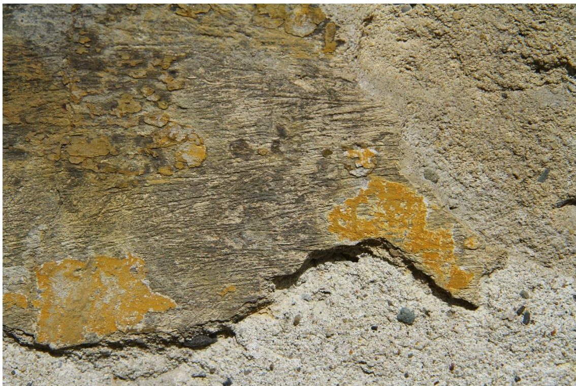
Fot.28 kamienica mieszkalna przy ul. Michałowskiego 7 w Krakowie. Najniższa (pierwotna?), warstwa kolorystyczna na powierzchni cokołu – odkrywka naturalna.
