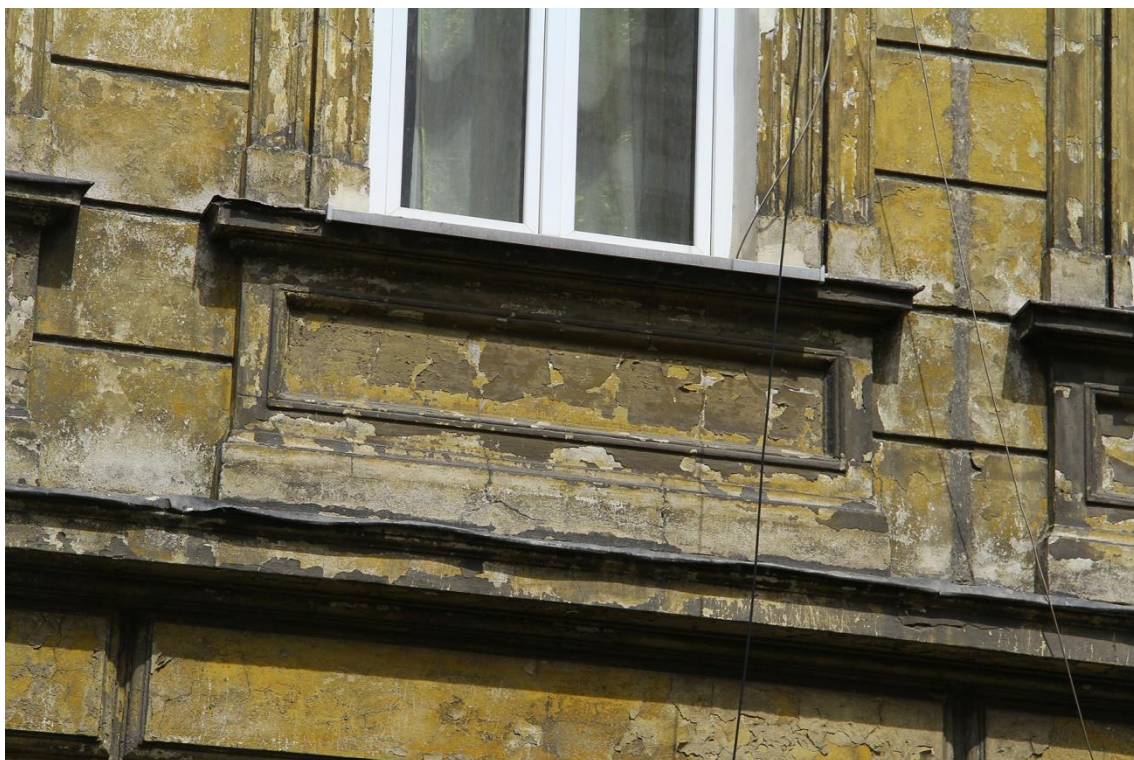
Fot.21 kamienica mieszkalna przy ul. michałowskiego 7 w Krakowie. Gzyms kordonowy parteru - fragment
