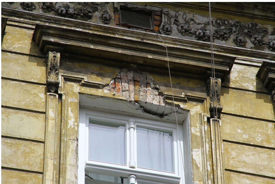
Fot.13 kamienica mieszkalna przy ul. michałowskiego 7 w Krakowie. Rozległy ubytek tynku i dekoracji w nadprożu okna czwartej osi na poziomie drugiego piętra.
