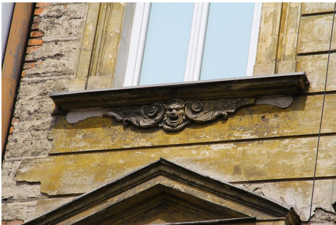
Fot.15 kamienica mieszkalna przy ul. Michałowskiego 7 w Krakowie. Rozległe ubytki tynków na lewej krawędzi elewacji, na poziomie, pomiędzy piętrami.
