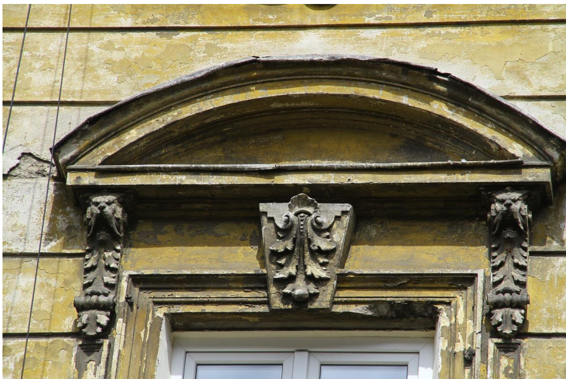
Fot.18 kamienica mieszkalna przy ul. Michałowskiego 7 w Krakowie. Nadproże okna drugiej osi pierwszego piętra, z widocznym złym stanem blacharki i odspojeniami w warstwie boniowania.
