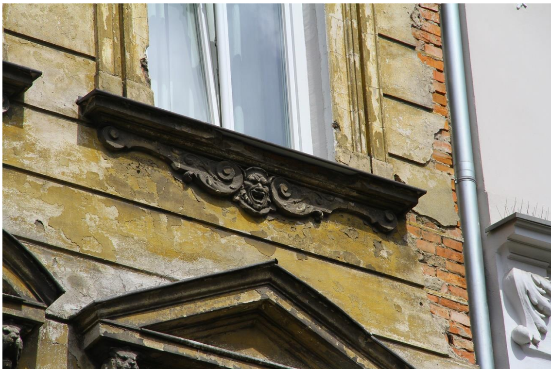
Fot.16 kamienica mieszkalna przy ul. Michałowskiego 7 w Krakowie. Głębokie ubytki warstwy tynkowej na prawej krawędzi elewacji, pomiędzy piętrami i widoczne nierówności na boniowaniu.
