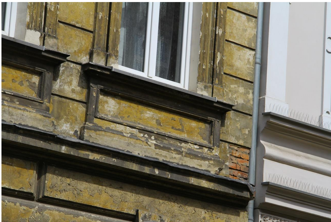
Fot.22 kamienica mieszkalna przy ul. michałowskiego 7 w Krakowie. Gzyms kordonowy parteru - fragment
