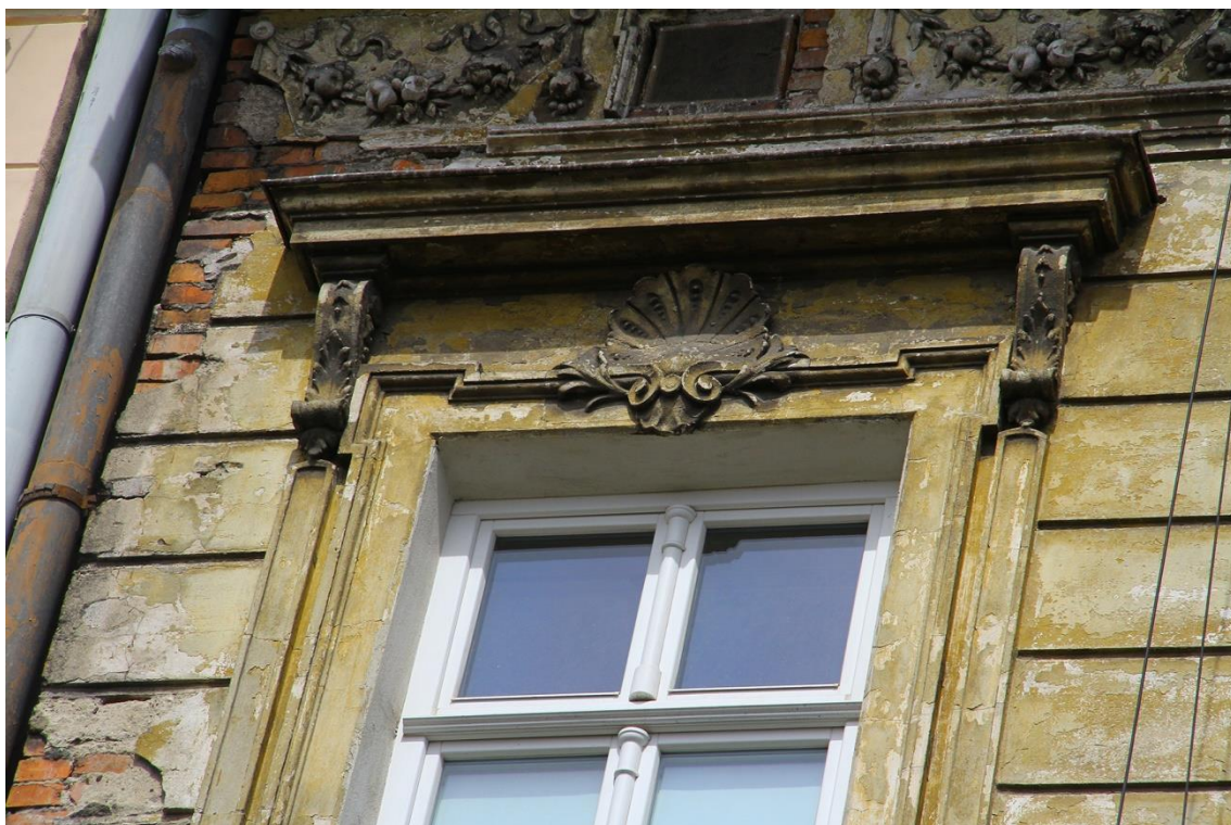
Fot.12 kamienica mieszkalna przy ul. Michałowskiego 7 w Krakowie. Zły stan zachowania warstwy tynkowej w lewym narożniku elewacji, na poziomie drugiego piętra.
