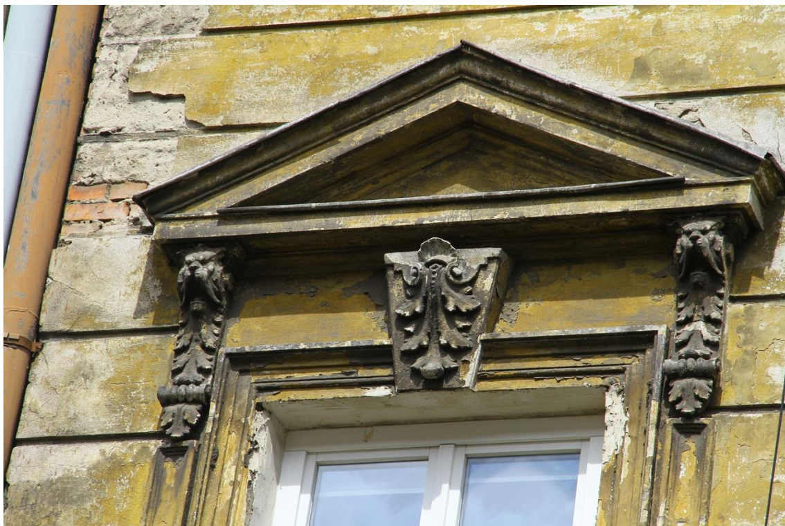
Fot.17 kamienica mieszkalna przy ul. Michałowskiego 7 w Krakowie. Dolna partia rozległych ubytków warstwy tynkowej na lewej krawędzi elewacji.
