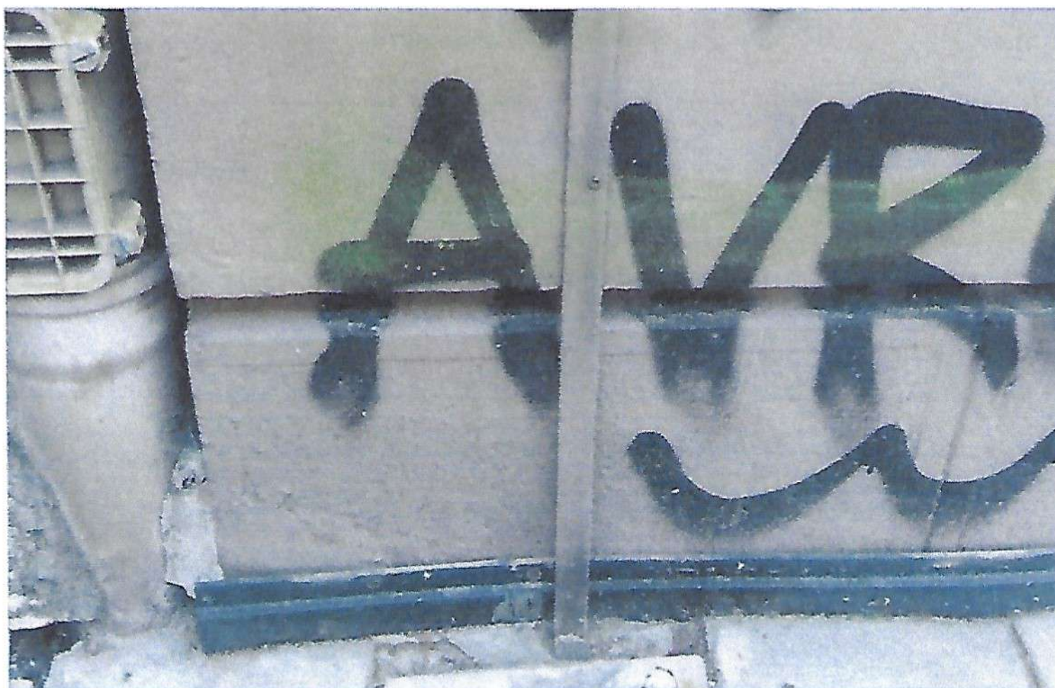
cokół z tynków tzw. terazzo kamieniarskich od widok od strony ulicy Felicjanek – elementy przemalowane i pokryte graffiti; uzupełniane wadliwymi zaprawami, dość niestarannie; widoczna także maskownica folii kubelkowej izolacji pionowej murów obiektu
