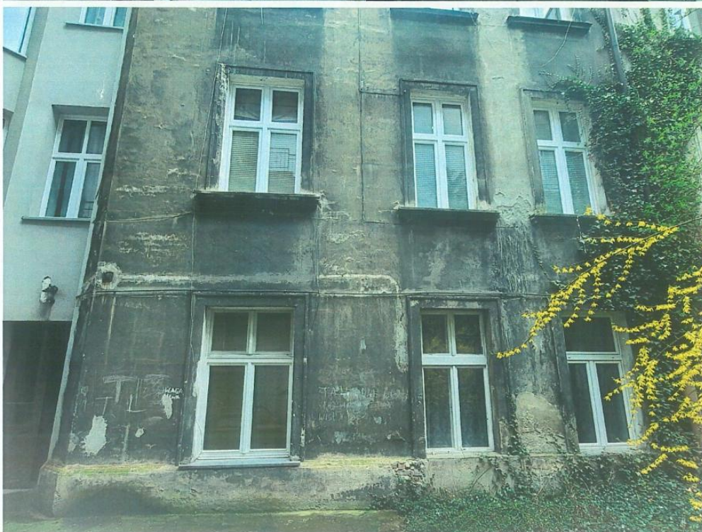
Fot 21,22. Kraków, ul. Sarego 25 – Elewacja frontowa oficyny tylnej – stan zachowania
