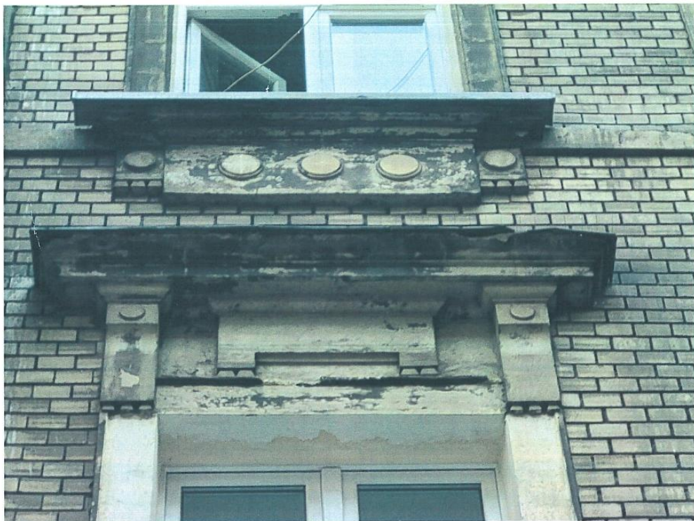
Fot 7, 8. Kraków, ul. Sarego 25 – elewacja frontowa – stan zachowania.
