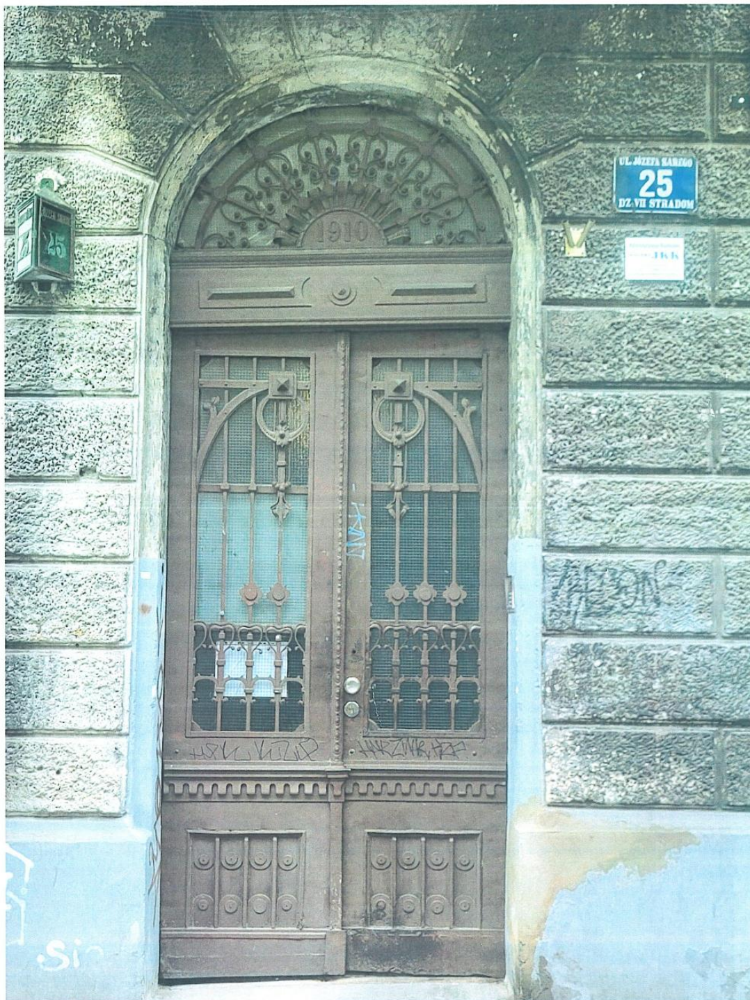
Fot 20. Kraków, ul. Sarego 25 – brama wejściowa – stan zachowania
