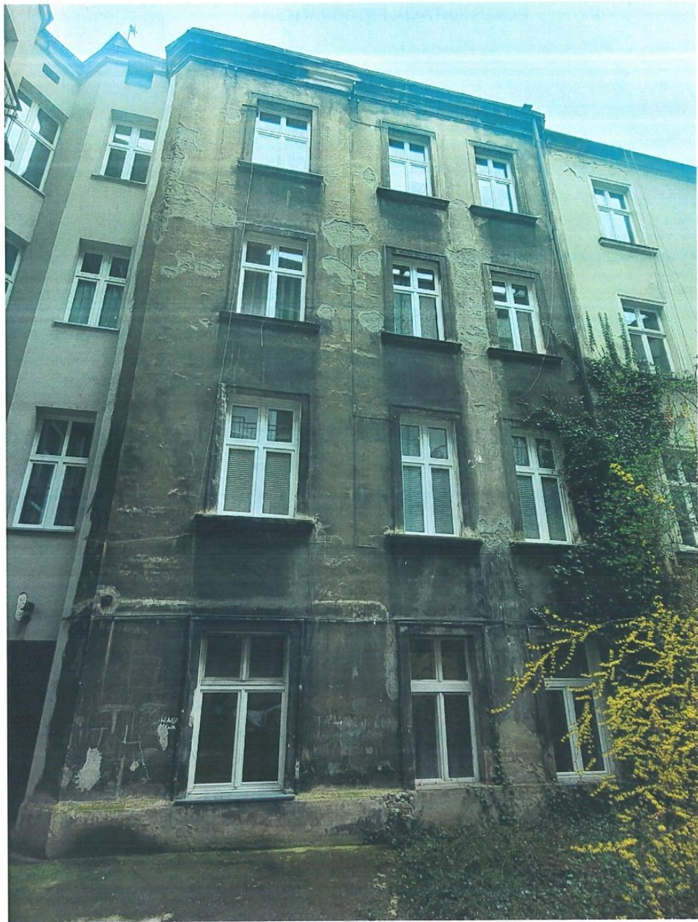
Fot 02. Kraków, ul. Sarego 25 – elewacja frontowa oficyny tylnej– stan zachowania.
