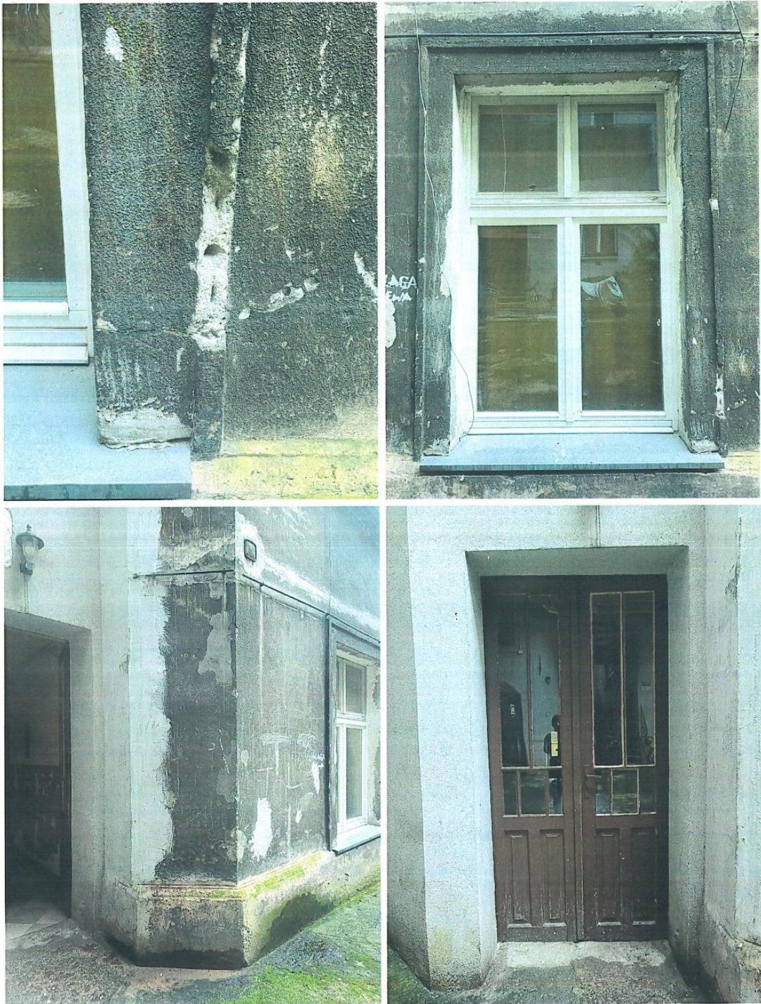
Fot 23, 24, 25, 26. Kraków, ul. Sarego 25 – Elewacja frontowa oficyny tylnej – stan zachowania
