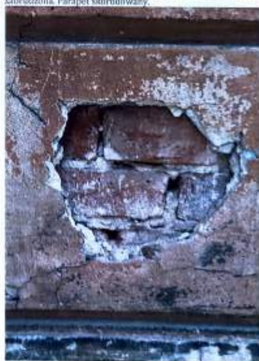
Fot.10.IV. Kamienica przy ul. Rejtana 8. Elewacja frontowa, fragment. Widoczny duży ubytek tynku do warstwy muru w partii botlowania.
