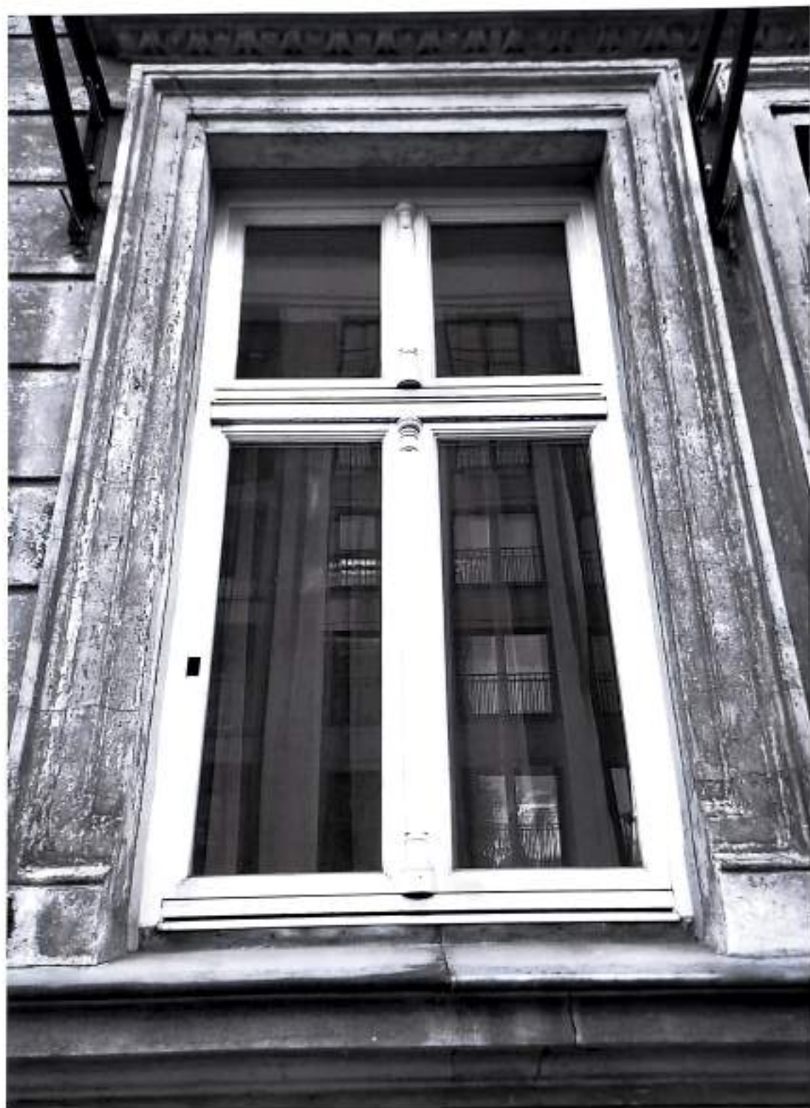
Fot. 4. Kamienica przy ul. Rejtana 8 w Krakowie. Elewacja frontowa, fragment. Widoczna stolarka okienna, wtórna, inspirowana historycznymi formami. Lipiec 2024 r.
