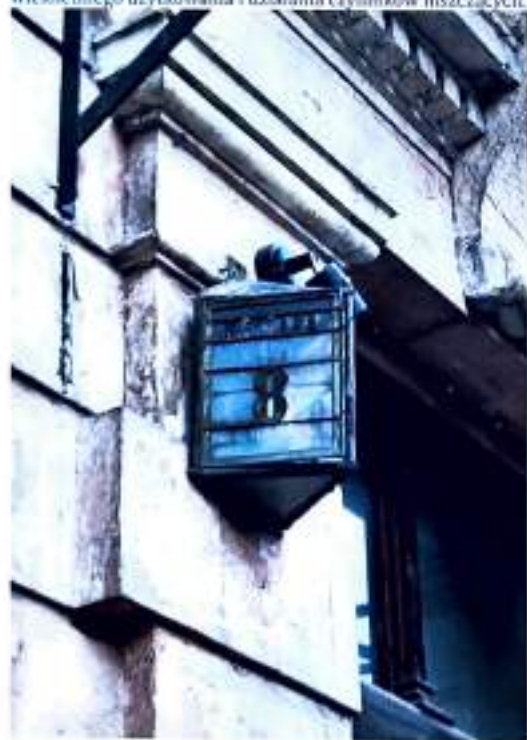
Fot.9.IV. Kamienica przy ul. Rejtana 8. Elewacja frontowa, fragment. Widoczna latarnia adresowa z korodującymi elementami.
