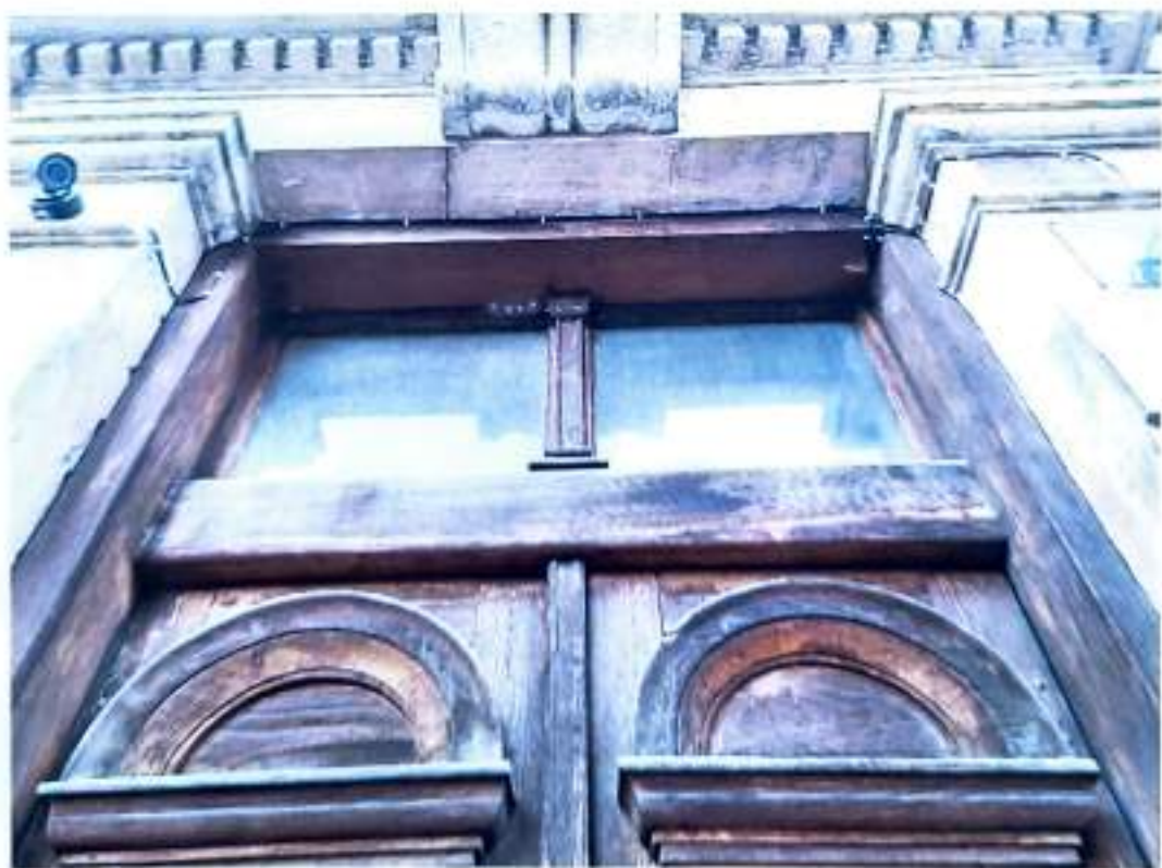
Fot.13.IV. Kamienica przy ul. Rejtana 8. Elewacja frontowa, fragment. Widoczny stan stolarki drzwi górnich.
