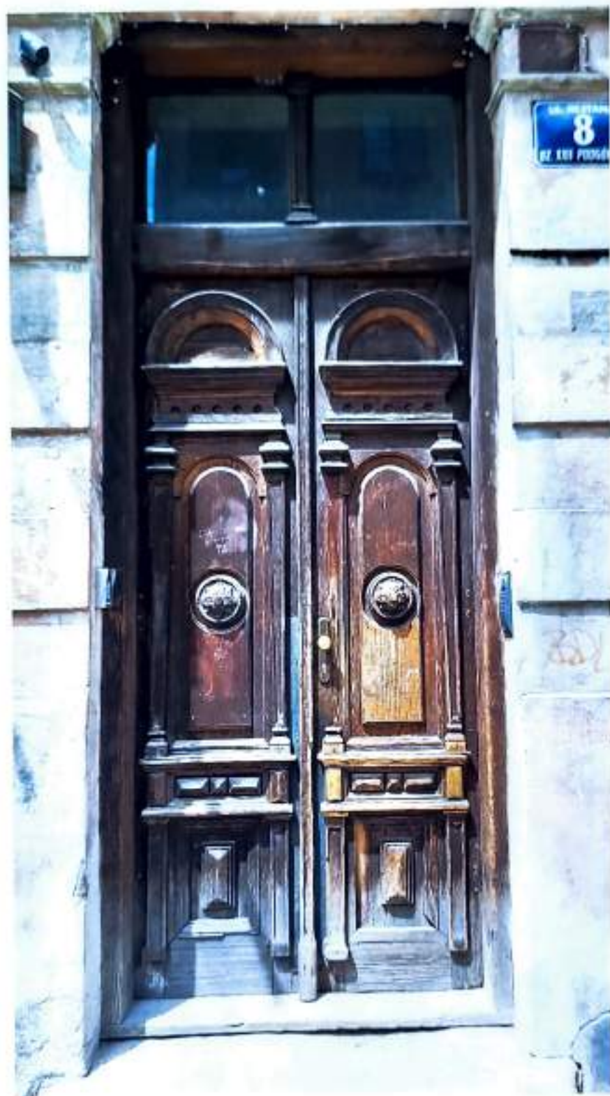
Fot. 2. Kamienica przy ul. Rejtana 8 w Krakowie. Elewacja frontowa, fragment. Widoczna historyczna stolarka drzwiowa. Lipiec 2024 r.
