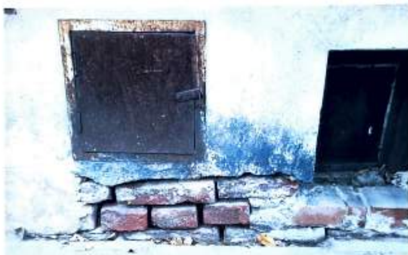
Fot. 1.IV. Kamienica przy ul. Rejtana 8. Elewacja frontowa, fragment. Widoczny zły stan tynków w partii przyziemnej, zniszczenia mechaniczne oraz spowodowane działaniem wody opadowej odbitej od powierzchni chodnika, wtórne, doraźne naprawy tynków. Bardzo zły stan metalowych drzewce oraz stolarki okiennej.
