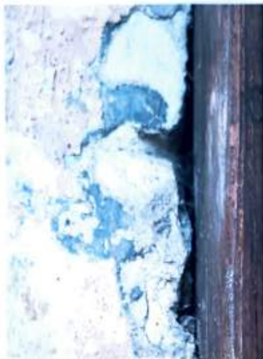
Fot.11.IV. Kamienica przy ul. Rejtana 8. Elewacja frontowa, fragment. Widoczny duży ubytek tynku do warstwy muru w partii boniowania.
