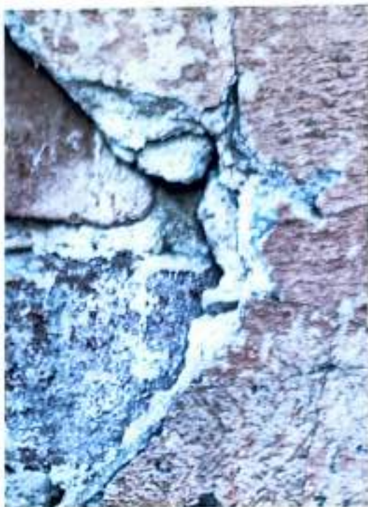
Fot.12.IV. Kamienica przy ul. Rejtana 8. Elewacja frontowa, fragment. Widoczny duży ubytek tynku do warstwy muru w partii boniowania.
