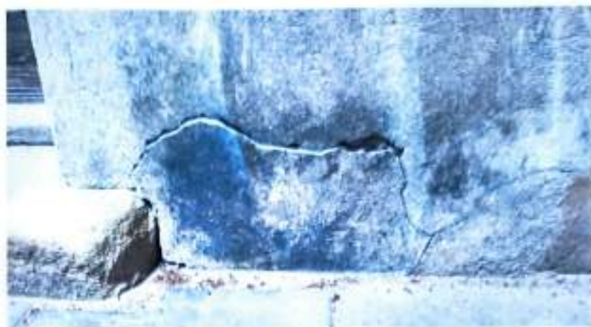
Fot.4.IV. Kamienica przy ul. Rejtana 8. Elewacja frontowa, fragment. Widoczny zły stan tynku w partii przyziemnej, spękania i zabrudzenie powierzchni. Kamienny stopień w złym stanie, widoczny naróżnił o mrozi wyoblonej formie w wyniku wieloletniego użytkowania i działania czynników niszczących.
