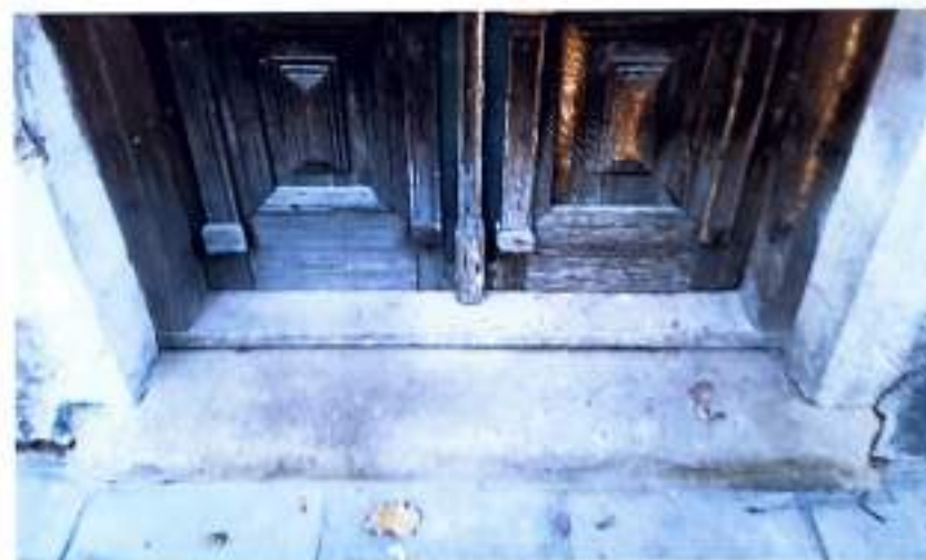
Fot.6.IV. Kamienica przy ul. Rejtana 8. Elewacja frontowa, fragment. Kamienny stopień w złym stanie, o mocno wyoblonej formie w wyniku wieloletniego użytkowania i działania czynników niszczących. Dolne partie stolarki drewnianej bez zabezpieczającej warstwy lakieru, drewno rozeszchnięte i wypukane, próg ponadto zniszczony mechanicznie.
