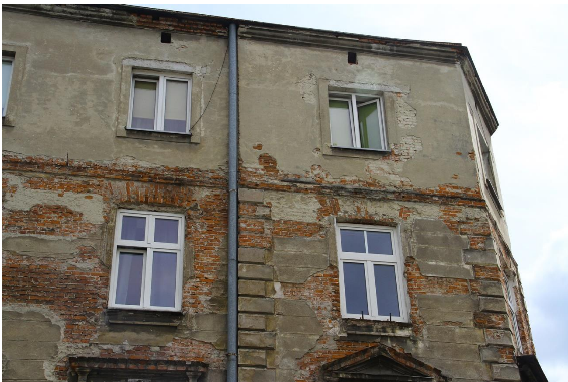
Fot. 4 kamienica mieszkalna przy ul. Studenckiej 29/Garncarska 10 w Krakowie. Elewacja od strony ul. Garncarskiej – prawa strona trzeciego i drugiego piętra.
