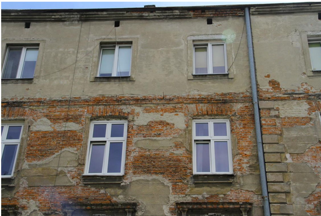
Fot. 3 kamienica mieszkalna przy ul. Studenckiej 29/Garncarska 10 w Krakowie. Elewacja od strony ul. Garncarskiej – środkowa część trzeciego i drugiego piętra.
