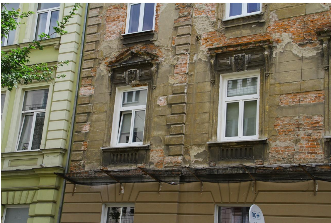
Fot. 5 kamienica mieszkalna przy ul. Studenckiej 29/Garncarska 10 w Krakowie. Elewacja od strony ul. Garncarskiej – lewa strona pierwszego piętra.
