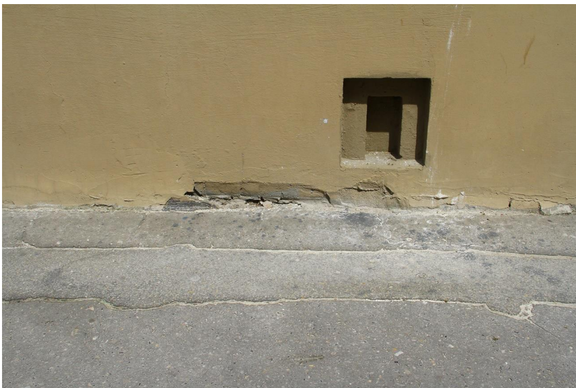
Fot. 24 kamienica mieszkalna przy ul. Studenckiej 29/Garncarska 10 w Krakowie. Nowe ubytki warstwy tynkarskiej na powierzchni cokołu, widoczne na elewacji od str. ul. Studenckiej.
