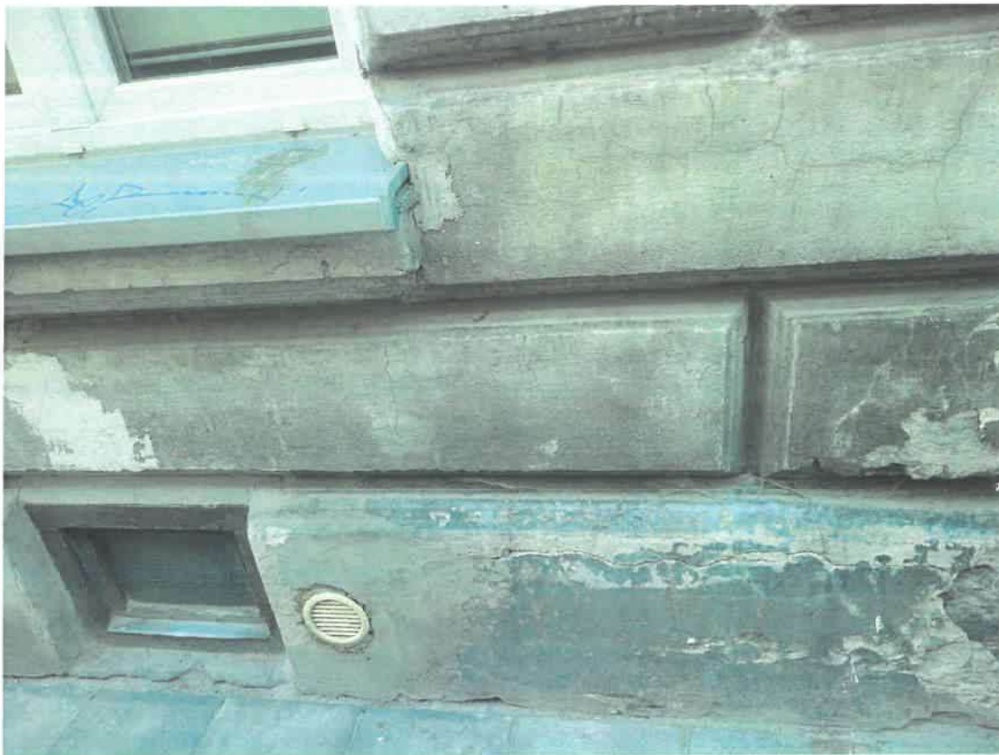
Fot 04. Kraków, ul. Felicjanek 21 – elewacja frontowa – stan zachowania.
