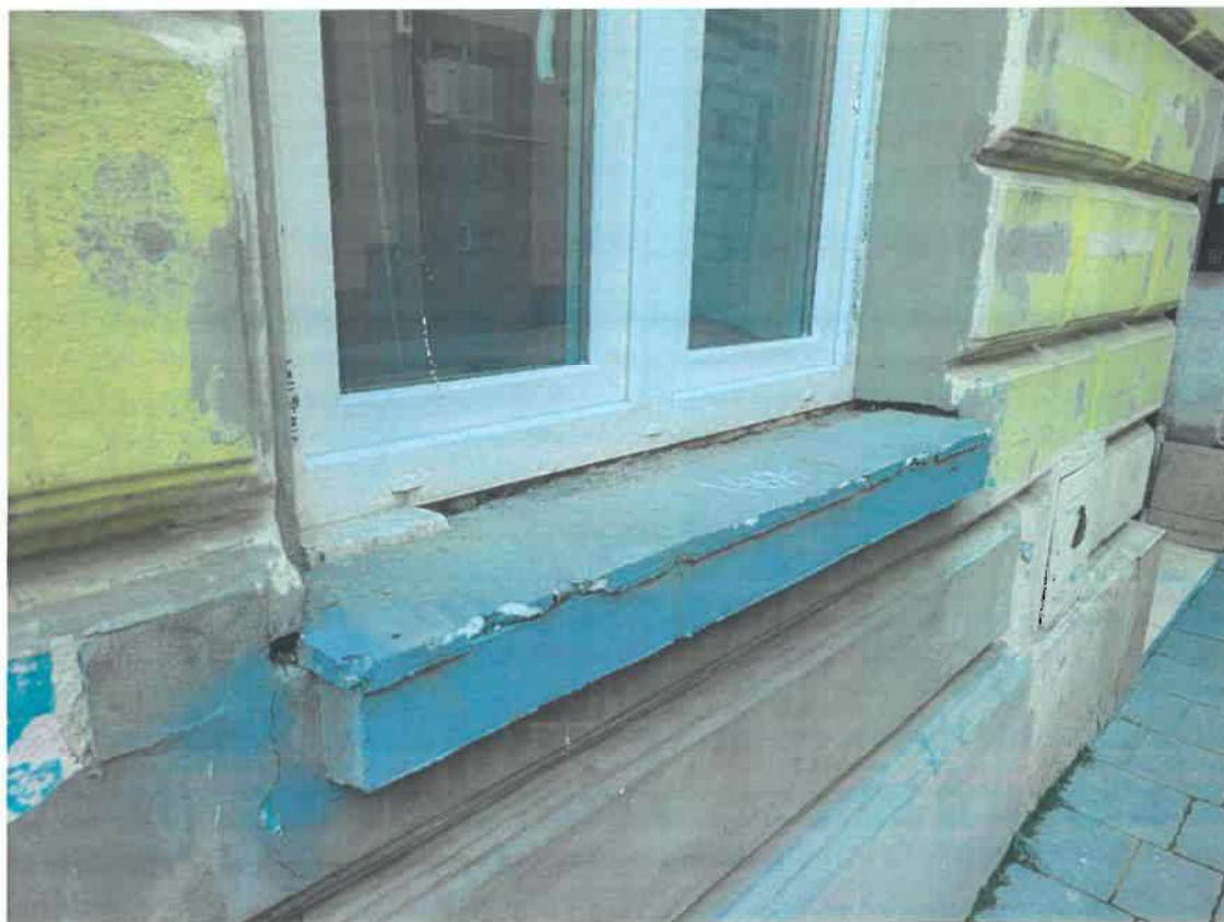
Fot 05. Kraków, ul. Felicjanek 21 – elewacja frontowa – stan zachowania.
