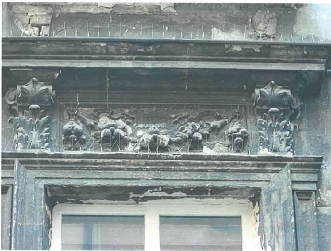
Fot 17, 18. Kraków, ul. Felicjanek 21 – elewacja frontowa – stan zachowania.
