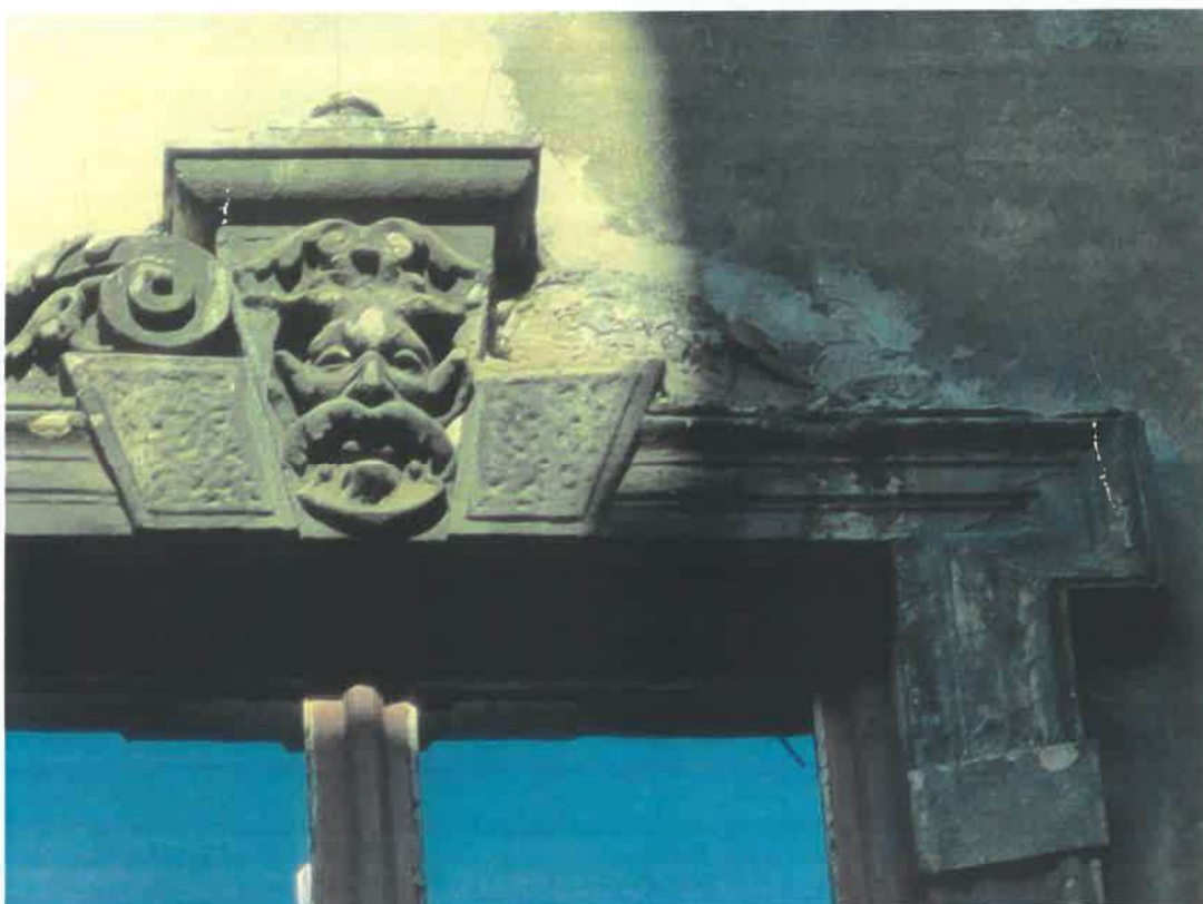
Fot 15, 16. Kraków, ul. Felicjanek 21 – elewacja frontowa – stan zachowania.
