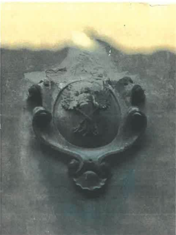
Fot 23, 24, 25. Kraków, ul. Felicjanek 21 – elewacja frontowa – stan zachowania.
