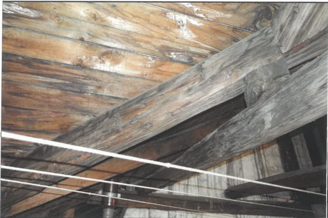
FOT. 23. KAMIENICA PRZY UL. JÓZEFA 1 W KRAKOWIE Fragment więźby w miejscach połączeń belek, stan przed konserwacją.
