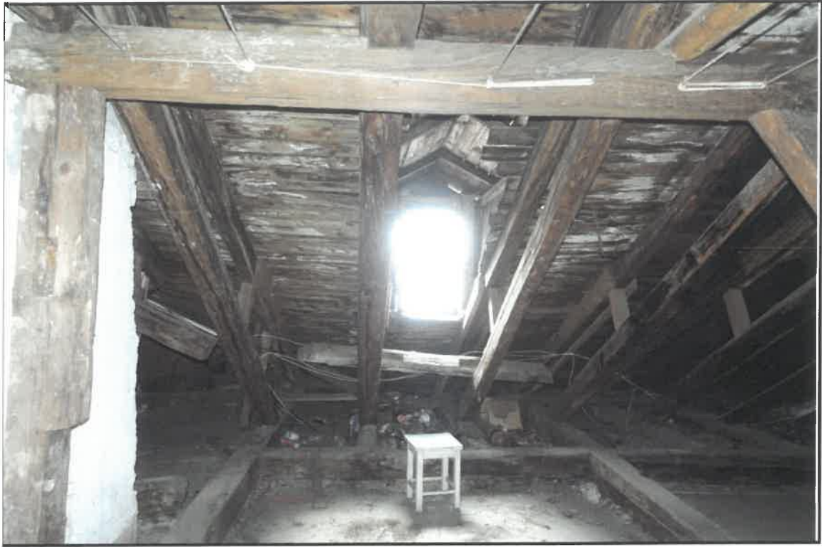
FOT. 11. KAMIENICA PRZY UL JÓZEFA 1 W KRAKOWIE Fragment więzby dachu z deskowaniem, stan przed konserwacją. MIASTA KRAKOWA BIURO ARCHITEKTURY I URBANISTYKI 31-545 Kraków, ul. Mogilska 41
