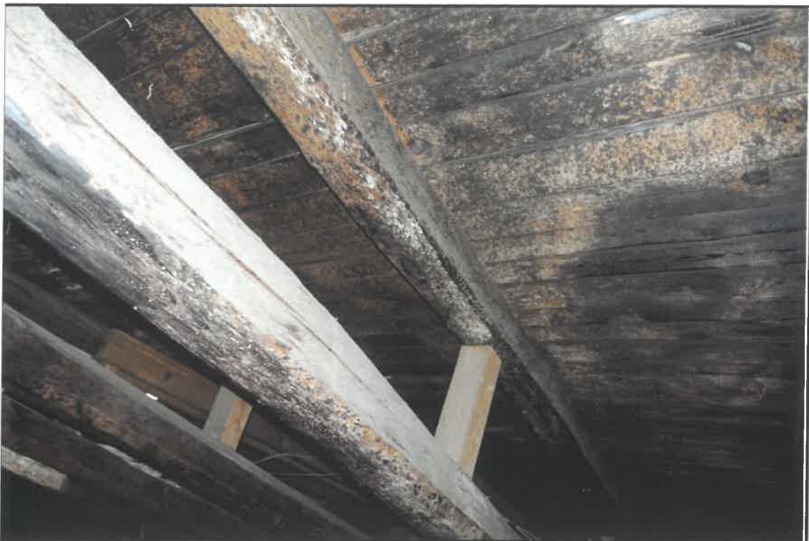
FOT. 21. KAMIENICA PRZY UL JÓZEFA 1 W KRAKOWIE Fragment więźby w miejscach połączeń belek, stan przed konserwacją.
