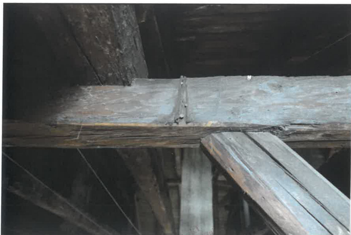
FOT. 24. KAMIENICA PRZY UL. JÓZEFA 1 W KRAKOWIE Fragment więźby w miejscach połączeń belek, stan przed konserwacją.
