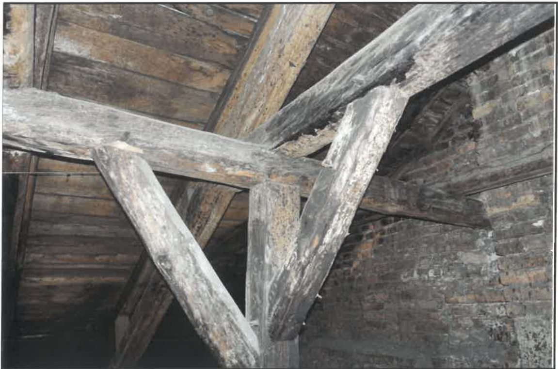
FOT. 18. KAMIENICA PRZY UL JÓZEFA 1 W KRAKOWIE Fragment więźby w miejscach połączeń belek, stan przed konserwacją.
