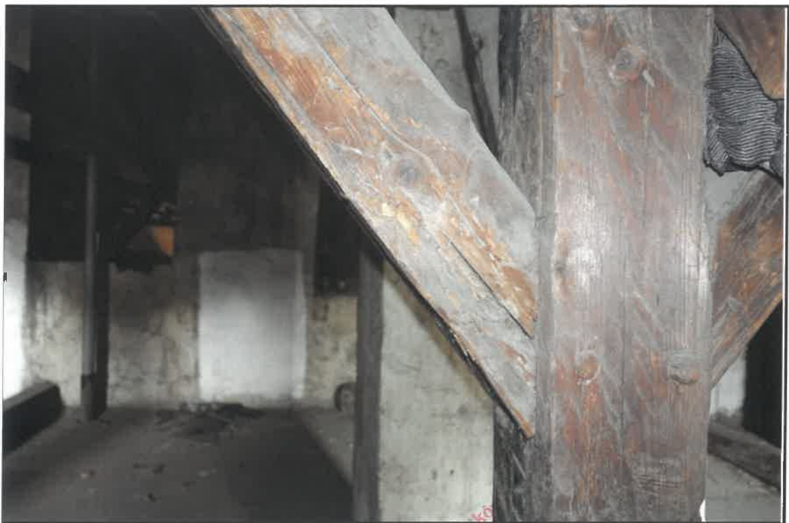
FOT. 20. KAMIENICA PRZY UL. JÓZEFA 1 W KRAKOWIE Fragment więźby w miejscach połączeń belek, stan przed konserwacją.
