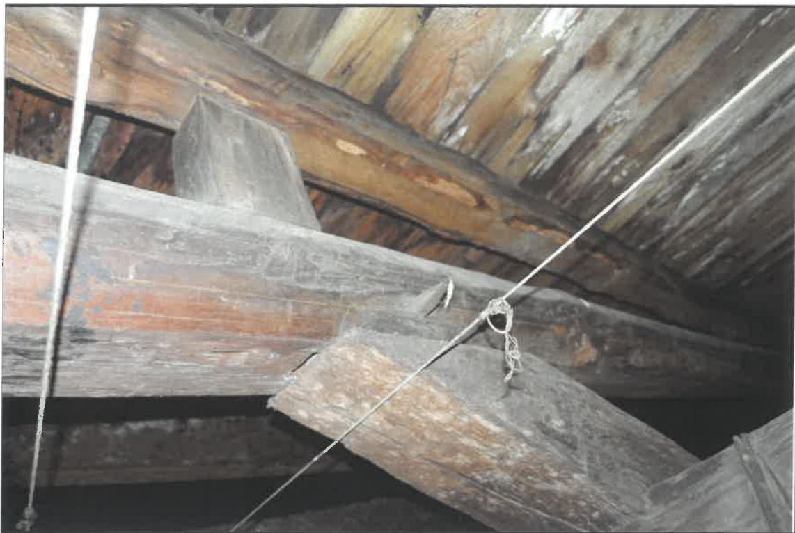
FOT. 25. KAMIENICA PRZY UL JÓZEFA 1 W KRAKOWIE Fragment więzby w miejscach połączeń belek, stan przed konserwacją.
