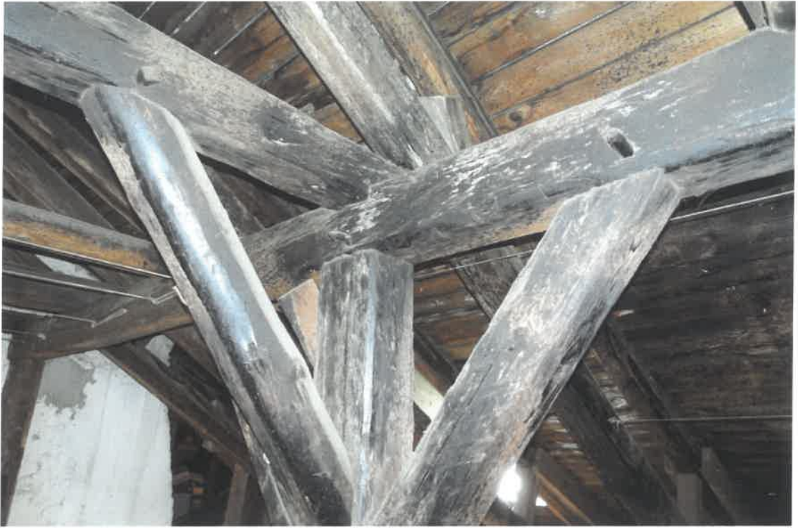
FOT. 17. KAMIENICA PRZY UL JÓZEFA 1 W KRAKOWIE Fragment więźby w miejscach połączeń belek, stan przed konserwacją.
