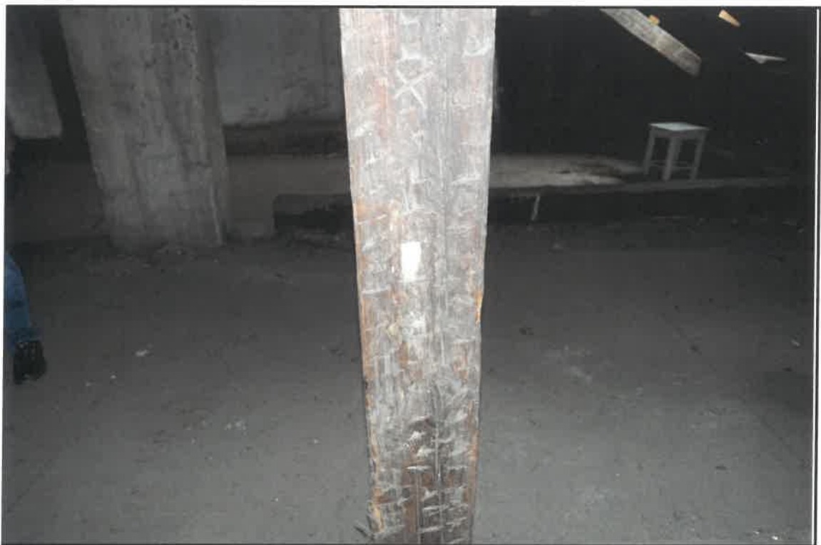
FOT. 28. KAMIENICA PRZY UL JÓZEFA 1 W KRAKOWIE Fragment więźby, stan przed konserwacją.
