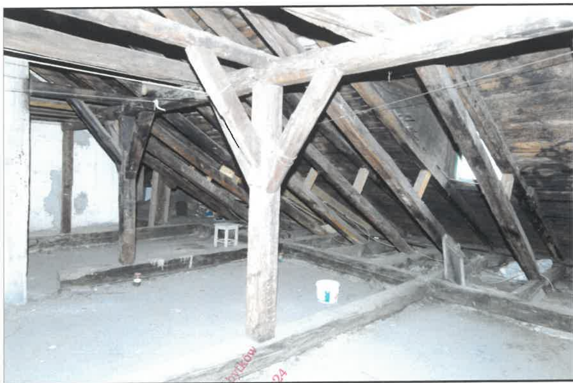
FOT. 4. KAMIENICA PRZY UL JÓZEFA 1 W KRAKOWIE Fragment więźby dachu, stan przed konserwacją.
