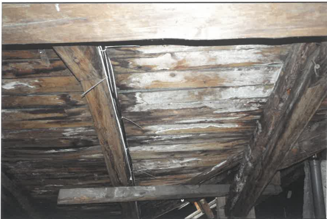
FOT. 13. KAMIENICA PRZY UL JÓZEFA 1 W KRAKOWIE Fragment więźby dachu z deskowaniem, stan przed konserwacją.
