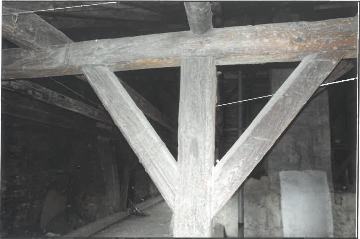
FOT. 19. KAMIENICA PRZY UL. JÓZEFA 1 W KRAKOWIE Fragment więźby w miejscach połączeń belek, stan przed konserwacją.
