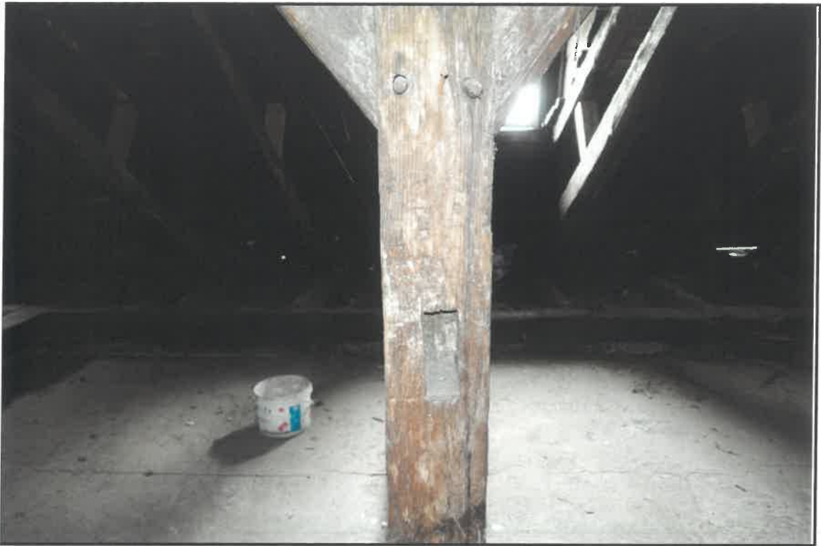
FOT. 27. KAMIENICA PRZY UL JÓZEFA 1 W KRAKOWIE Fragment więźby, stan przed konserwacją.
