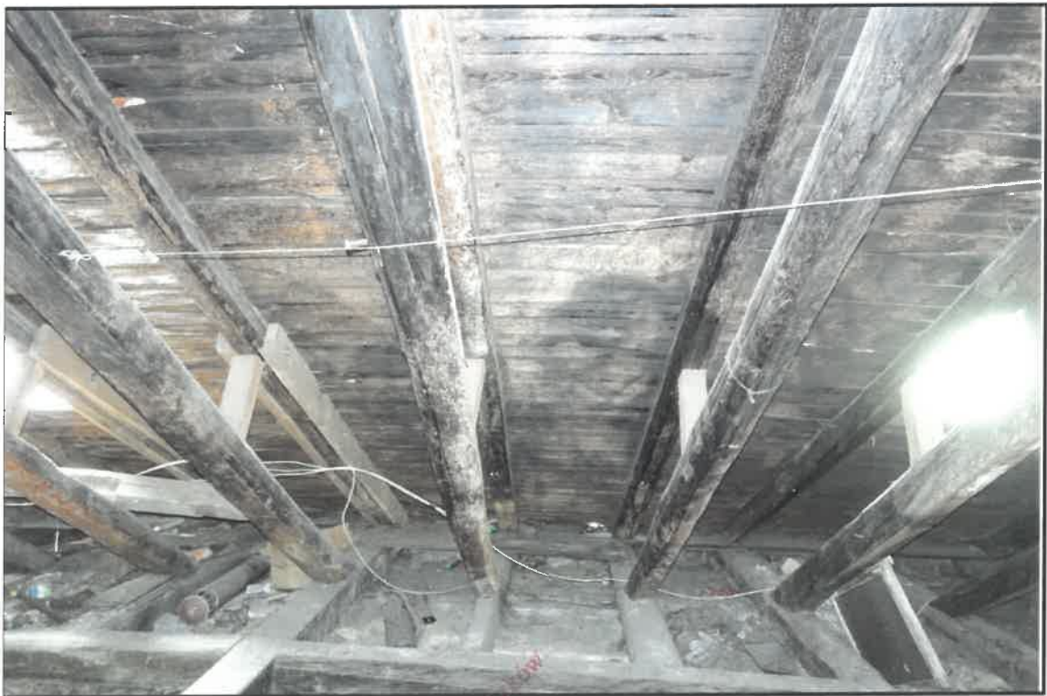
FOT. 12. KAMIENICA PRZY UL JÓZEFA 1 W KRAKOWIE Fragment więzby dachu z deskowaniem, stan przed konserwacją. wojewódzki konserwator Zabytków w Krakowie, ul. Janowska 24 31-002 Kraków, ul. Janowska 24
