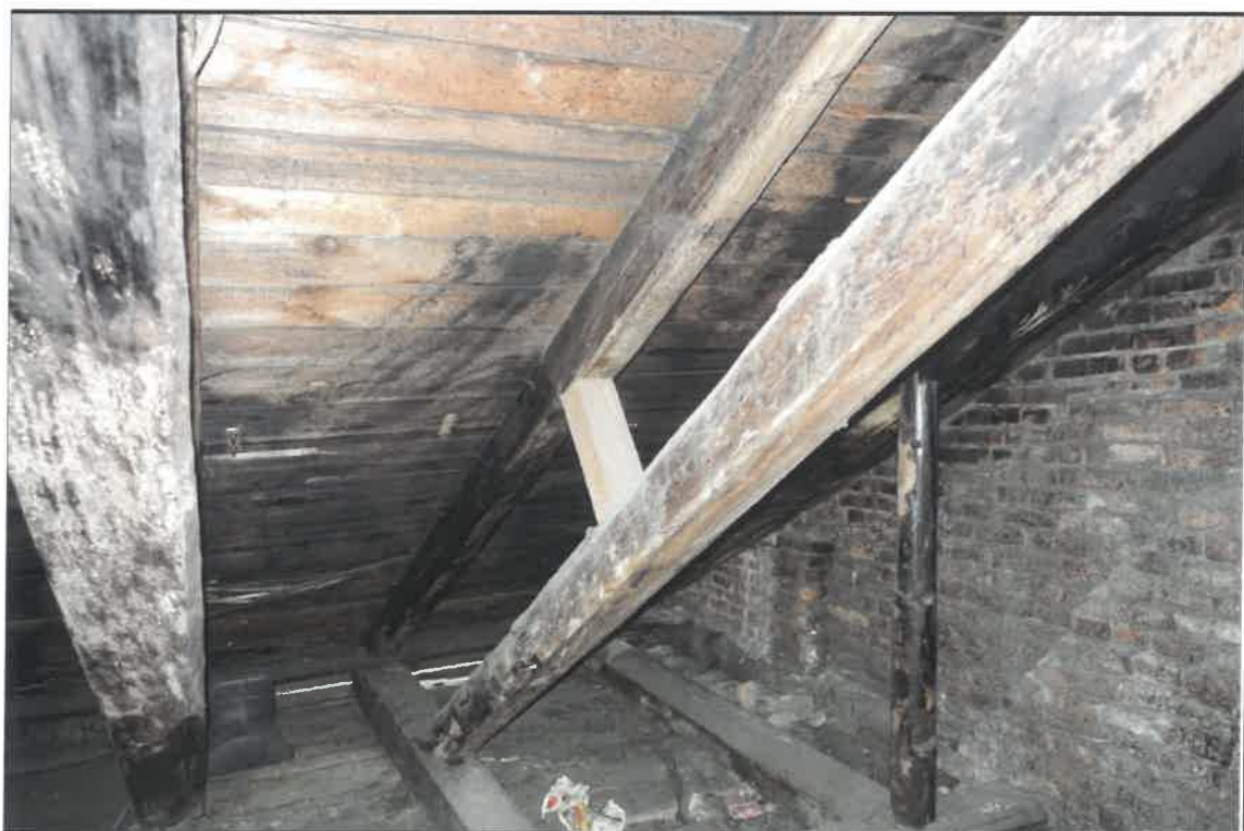
FOT. 22. KAMIENICA PRZY UL JÓZEFA 1 W KRAKOWIE Fragment więźby w miejscach połączeń belek, stan przed konserwacją.
