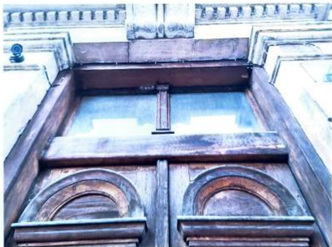
Fot.13.IV. Kamienica przy ul. Rejtana 8. Elewacja frontowa, fragment. Widoczny stan stolarki drzwi górnycych.
