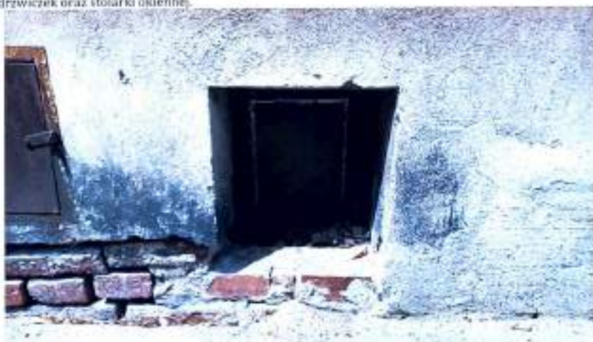
Fot. 2.IV. Kamienica przy ul. Rejtana 8. Elewacja frontowa, fragment. Widoczny zły stan tynków w partii przyziemnej, zniszczenia mechaniczne oraz spowodowane działaniem wody opadowej odbitej od powierzchni chodnika, wtórne, doraźne naprawy tynków. Zły stan stolarki okiennej.
