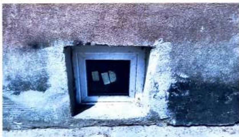
Fot. 3.IV. Kamienica przy ul. Rejtana 8. Elewacja frontowa, fragment. Widoczny zły stan tynku w partii przyziemnej, ubytko do muru, wtórne, niestarsanne naprawy, zabrudzenie oraz zły stan stolarki okiennej.
