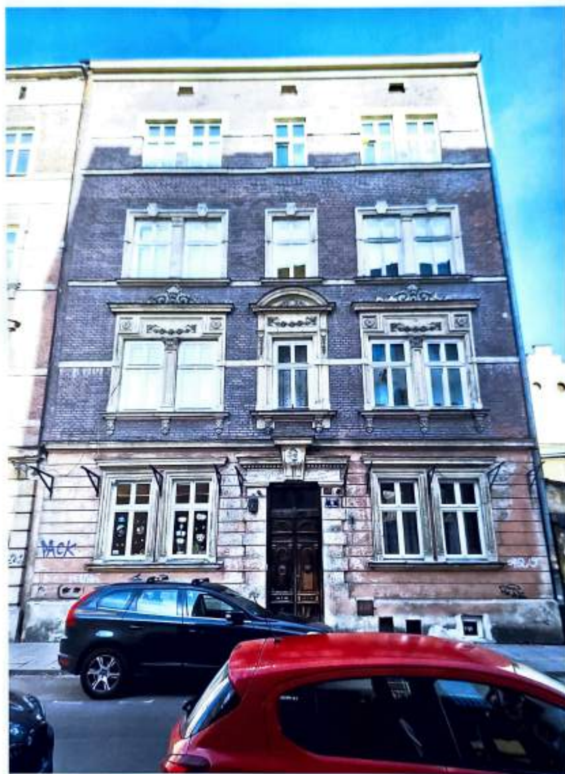
Fot. 1. Kamienica przy ul. Rejtana 8 w Krakowie. Elewacja frontowa. Widoczny dość dobry ogólny stan elewacji, zniszczenia skoncentrowane w partii I kondygnacji. Lipiec 2024 r.
