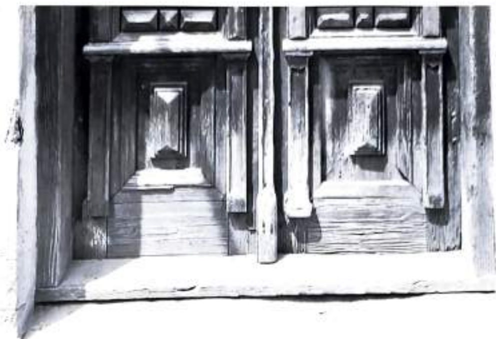
Fot.14.IV. Kamienica przy ul. Rejtana 8. Elewacja frontowa, fragment. Widoczny stan stolarki drzwi głównych. Zniszczona przez użytkowanie dolna część drzwi.
