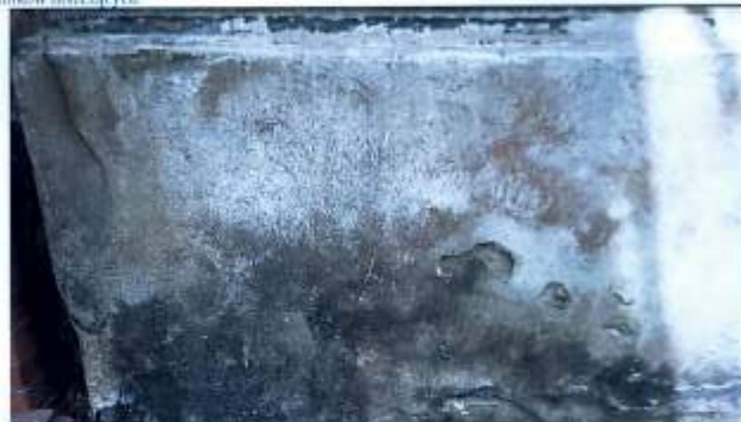
Fot.5.IV. Kamienica przy ul. Rejtana 8. Elewacja frontowa, fragment. Widoczny zły stan tynku w partii cokolu, zabrudzenie, spękanie i ubytki.
