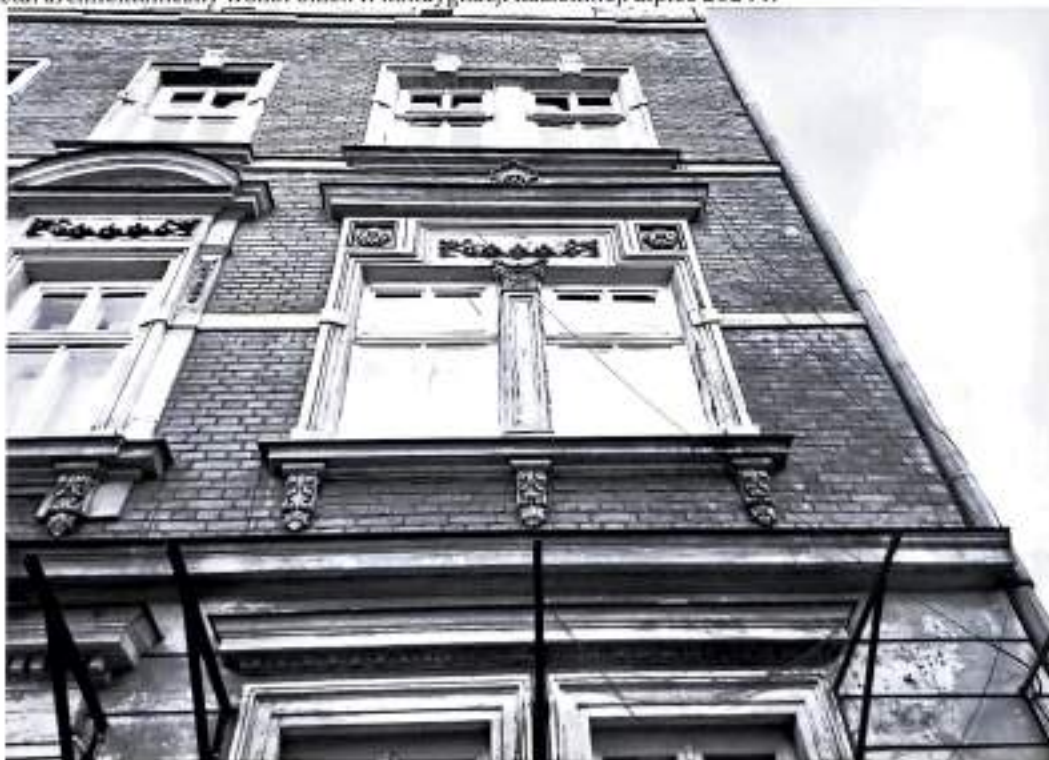
Fot. 6. Kamienica przy ul. Rejtana 8 w Krakowie. Elewacja frontowa, fragment. Lipiec 2024 r.
