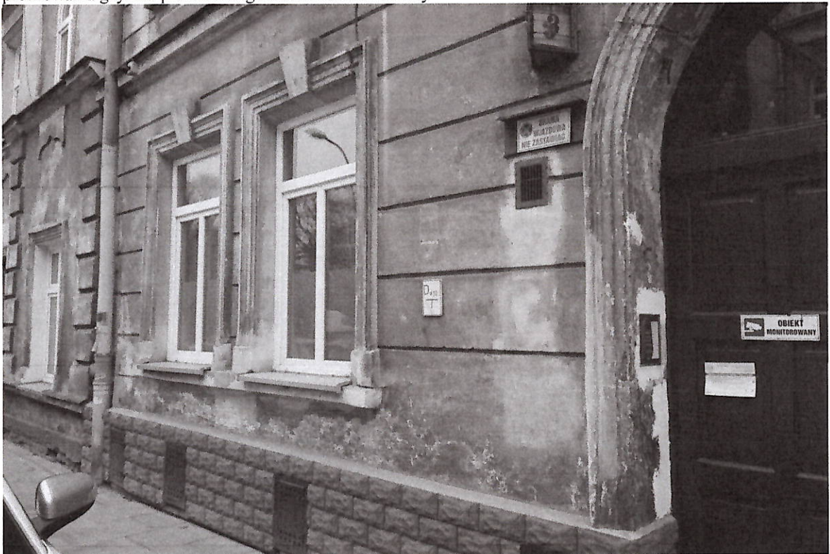
Kraków ul.Krasickiego 3 .Elewacja frontowa -detal. Stan przed konserwacją. Widoczne zabrudzenia , cementowa okładzina cokołu oraz niedopasowane obróbki parapetów. Widoczne trójpółowe okna .
