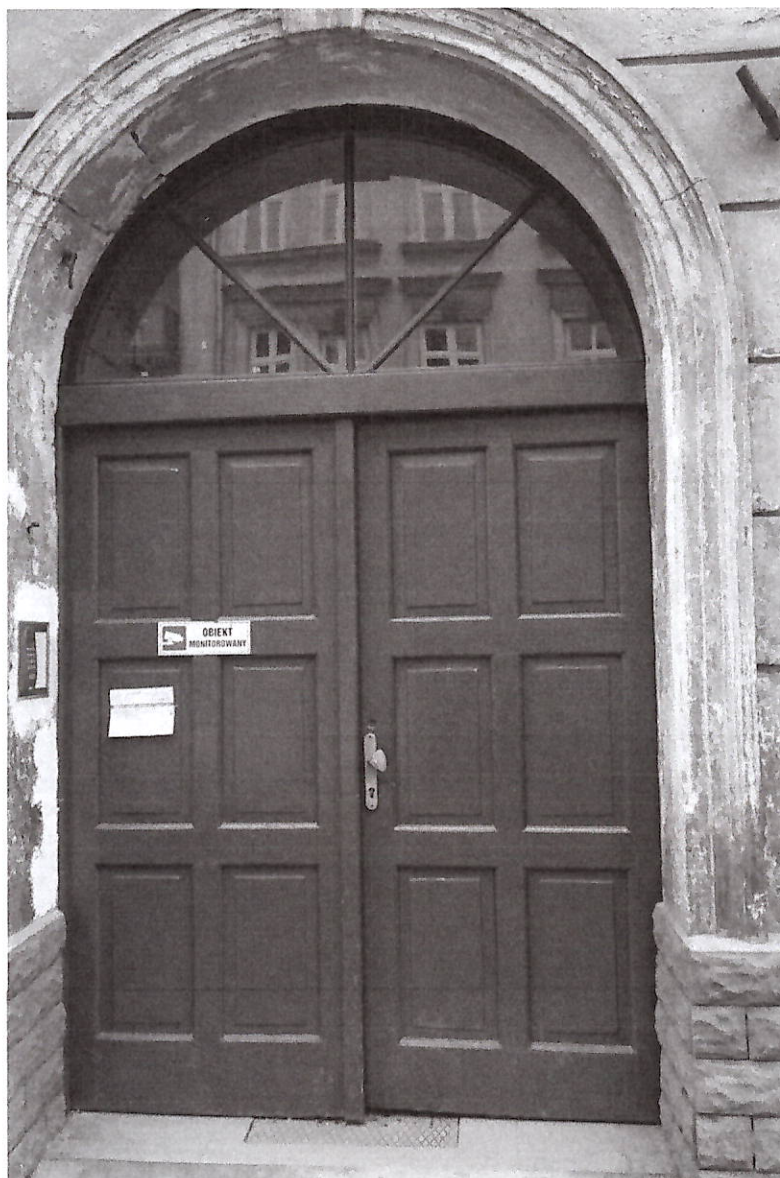
Kraków ul.Krasickiego 3 .Elewacja frontowa –brama wejściowa . Stan przed konserwacją.
