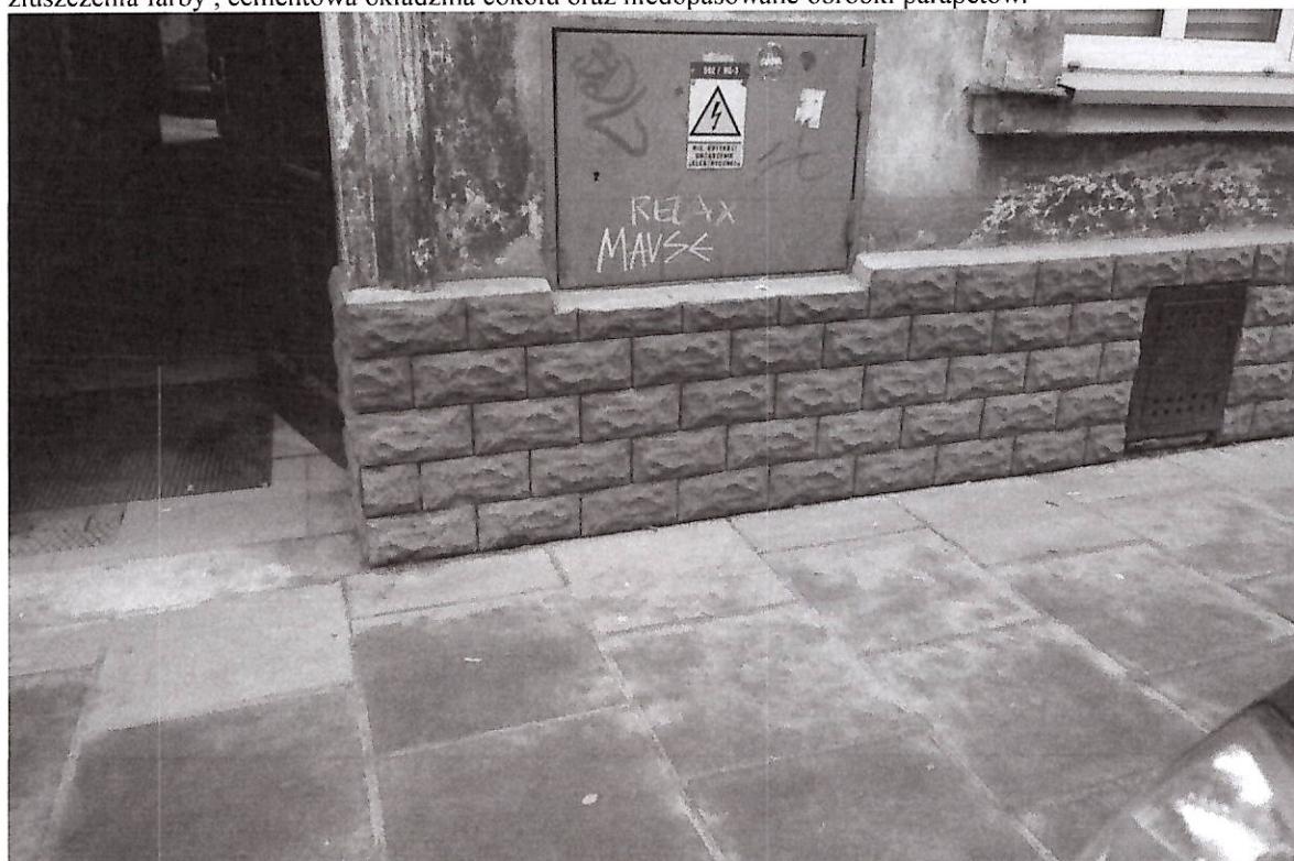
Kraków ul.Krasickiego 3 .Elewacja frontowa -detal. Stan przed konserwacją. Widoczna cementowa okładzina cokołu i zabrudzenia tynku powyżej cokołu
