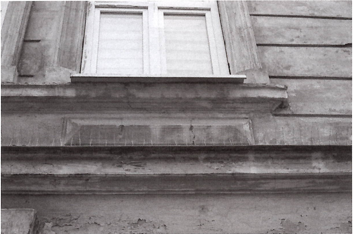
Kraków ul.Krasickiego 3 .Elewacja frontowa -detal. Stan przed konserwacją. Widoczne zabrudzenia ,ubytki profilowania gzymsu podokiennego oraz złuszczenia farby
