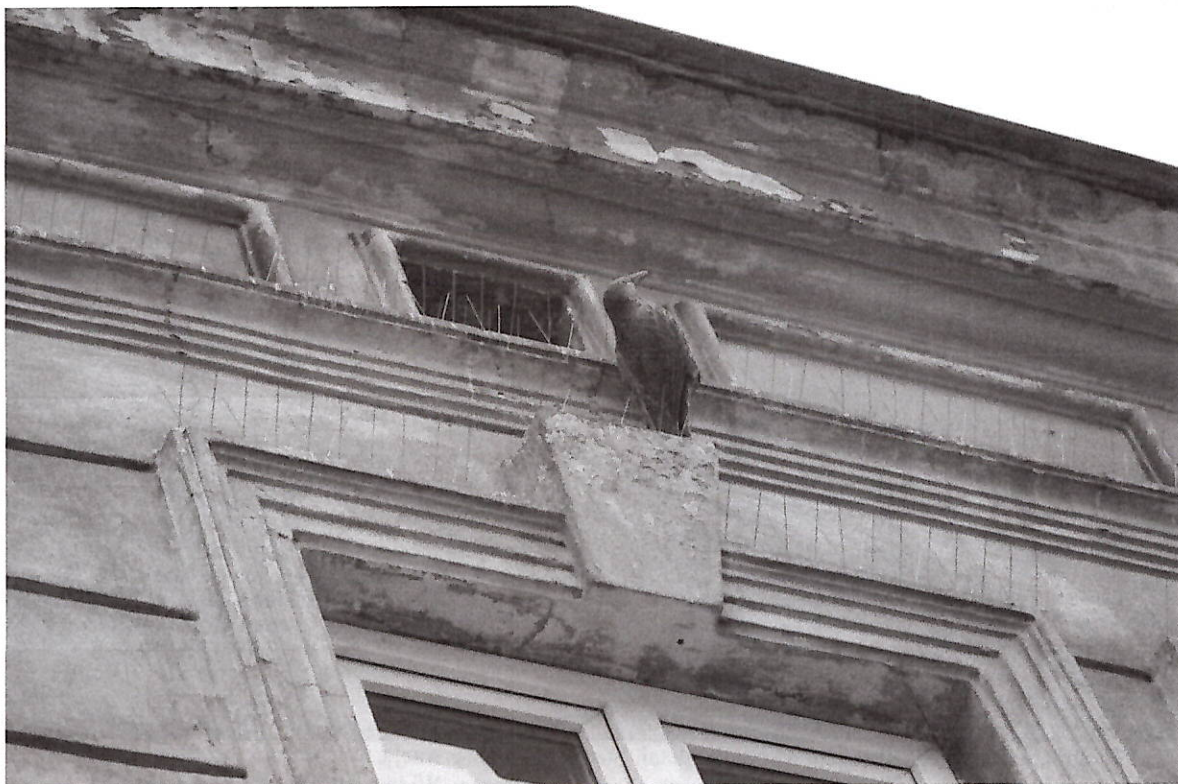
Kraków ul.Krasickiego 3 .Elewacja frontowa -detal. Stan przed konserwacją. Widoczne zabrudzenia ,ubytki profilowania gzymsu wieńczącego oraz spękania profilowań wokół okien.
