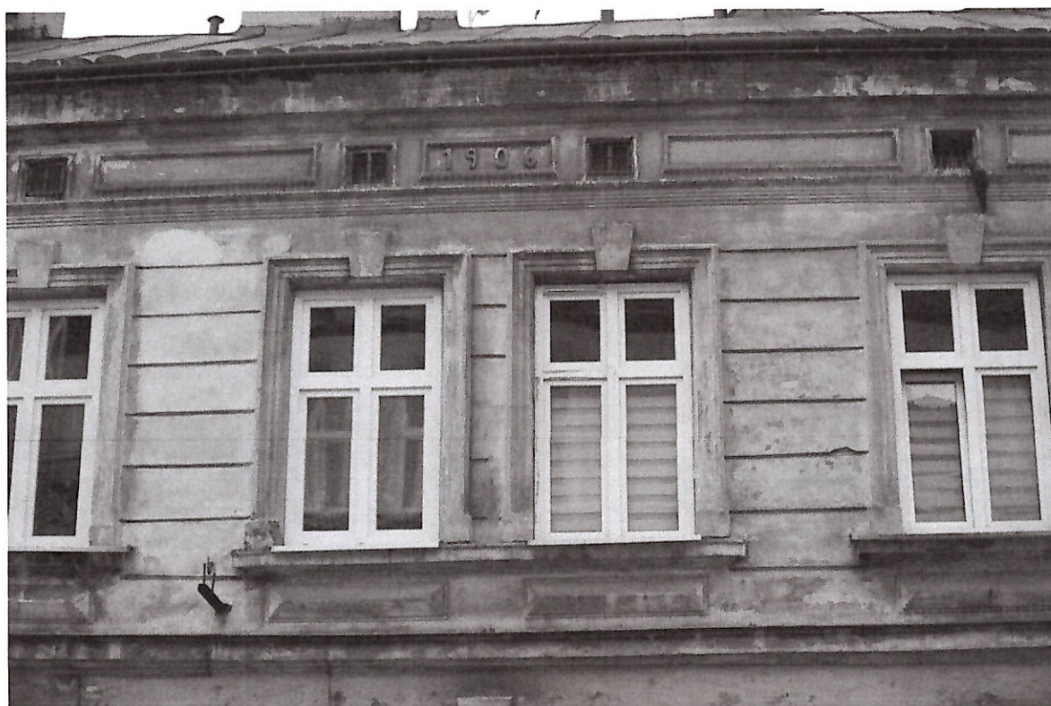
Kraków ul.Krasickiego 3 .Elewacja frontowa -detal. Stan przed konserwacją. Widoczne zabrudzenia oraz ubytki profilowania gzymsu wieńczącego
