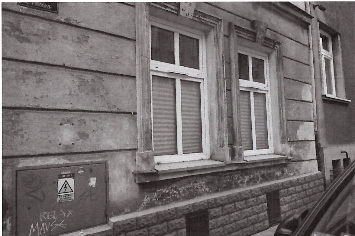
Kraków ul.Krasickiego 3 .Elewacja frontowa -detal. Stan przed konserwacją. Widoczne zabrudzenia , złuszczenia farby , cementowa okładzina cokołu oraz niedopasowane obróbki parapetów.
