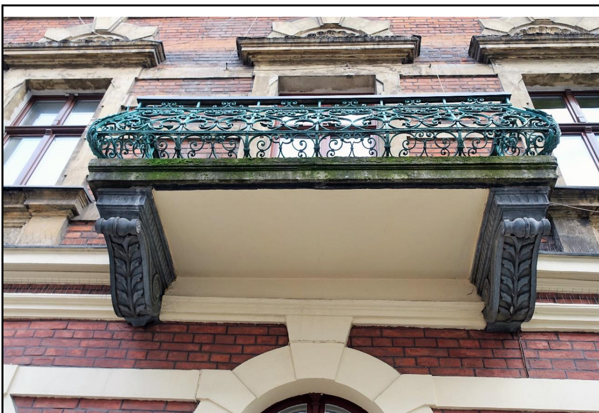
Fot. 16. KAMIENICA PRZY UL. STUDENCKIEJ 7 W KRAKOWIE. Podest balkonu, stan przed konserwacją. Marzec 2024 r.
