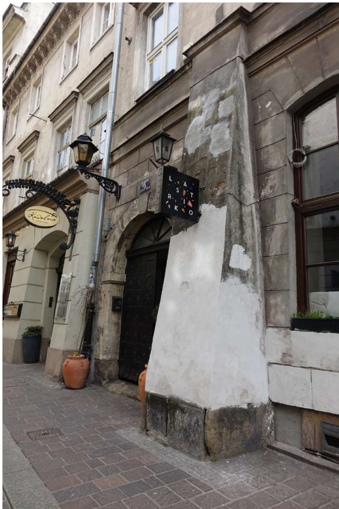
Fot. 10 Kraków, fasada kamienicy przy ulicy Gołębiej 6. Widoczna przypora od strony wschodniej z silnie zabrudzoną i zawilgoconą powierzchnią. W górnej części przypory ubytki do wążku ceglanego oraz wtórne naprawy tynku. Wtórne płyty cokołu od frontu przypory. Stan przed konserwacją.
