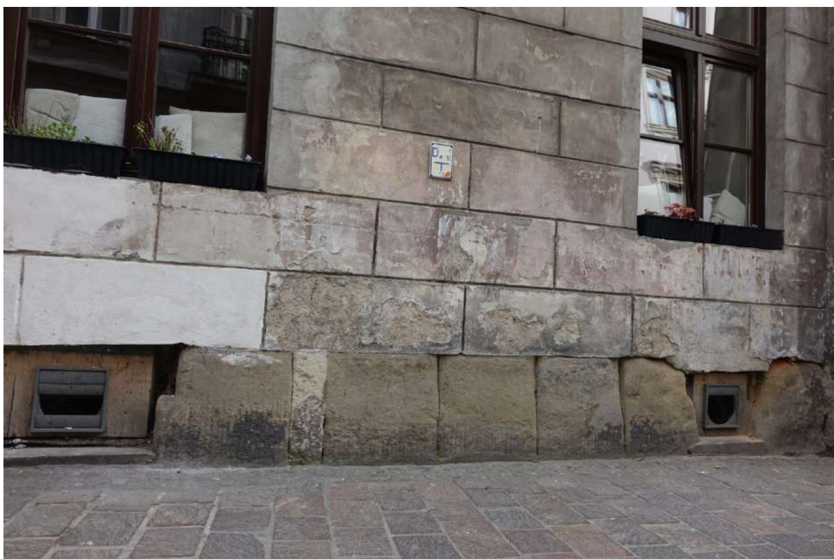
Fot. 4, 5 Kraków, fasada kamienicy przy ulicy Gołębiej 6. Widoczna kondygnacja parteru, ubytki w strukturze kamiennego cokołu, zabrudzenie powierzchni boniowania, prowizoryczne naprawy w obrębie przypory. Stan przed konserwacją.
