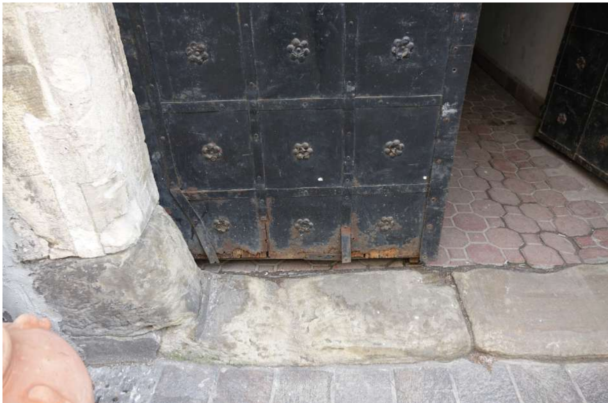
Fot. 6, 7 Kraków, fasada kamienicy przy ulicy Gołębiew 6. Portal i brama w osi wschodniej. Widoczne zabrudzenie kamienia, zawilgocenie powierzchni, destrukcja formy w obrębie progu. Ubytki i korozja metalowej dekoracji drzwi. Stan przed konserwacją.
