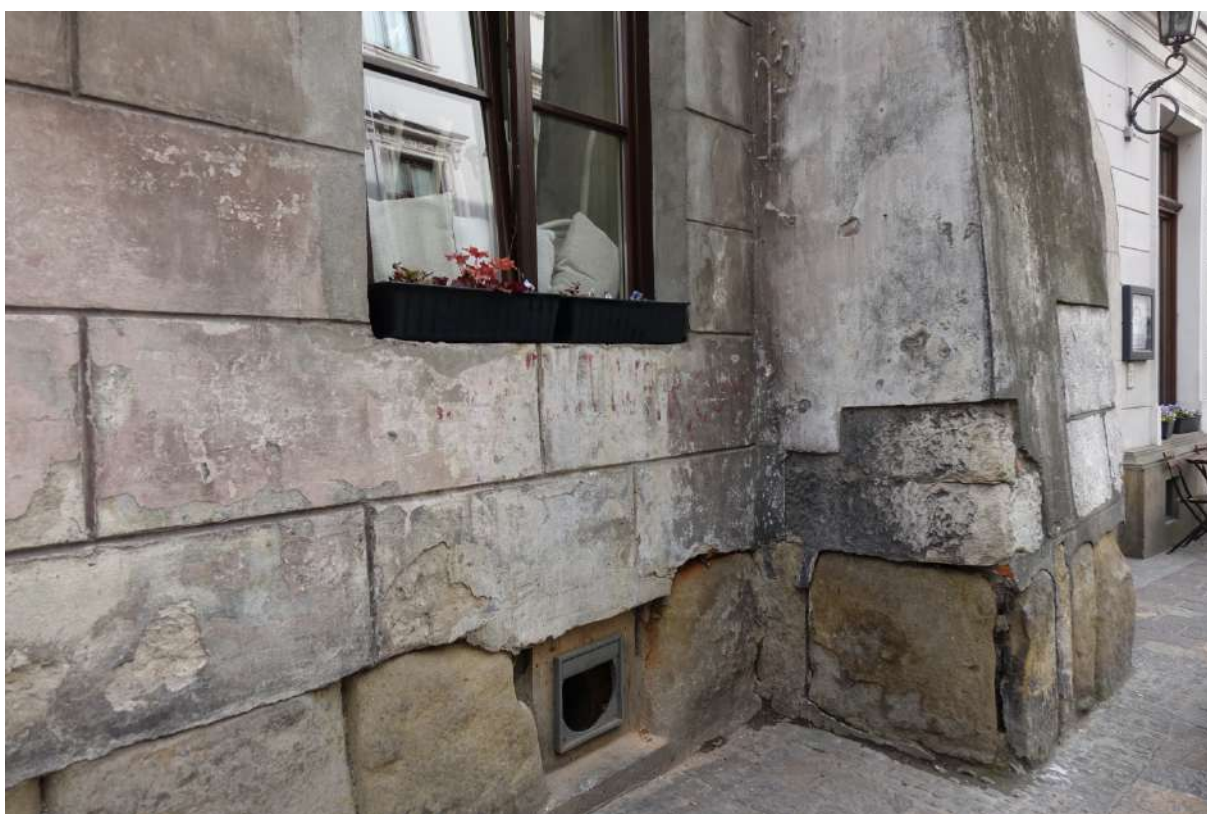
Fot. 8,9 Kraków, fasada kamienicy przy ulicy Gołębiej 6. Widoczna mocno zabrudzona powierzchnia i odbarwienia w partiach wtórnych uzupełnień kamiennego portalu.
