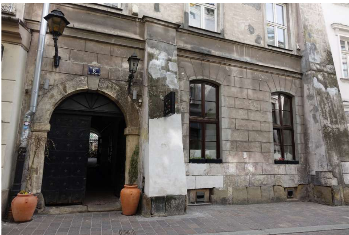
Fot. 2, 3 Kraków, fasada kamienicy przy ulicy Gołębiej 6. Widok ogólny wszystkich kondygnacji. Stan przed konserwacją.
