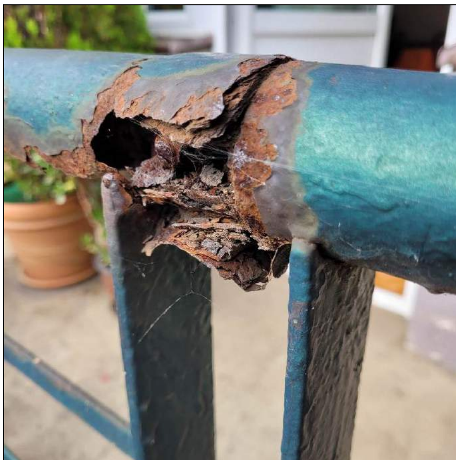
Fot. 15,16 Kamienica przy ul. Krakowskiej 49, fasada. Balustrada z metalowych płaskowników zachowana w dobrym stanie z wyjątkiem pochwyty. Tutaj liczne ogniska korozji. Wrzesień 2022r. M. Wida
