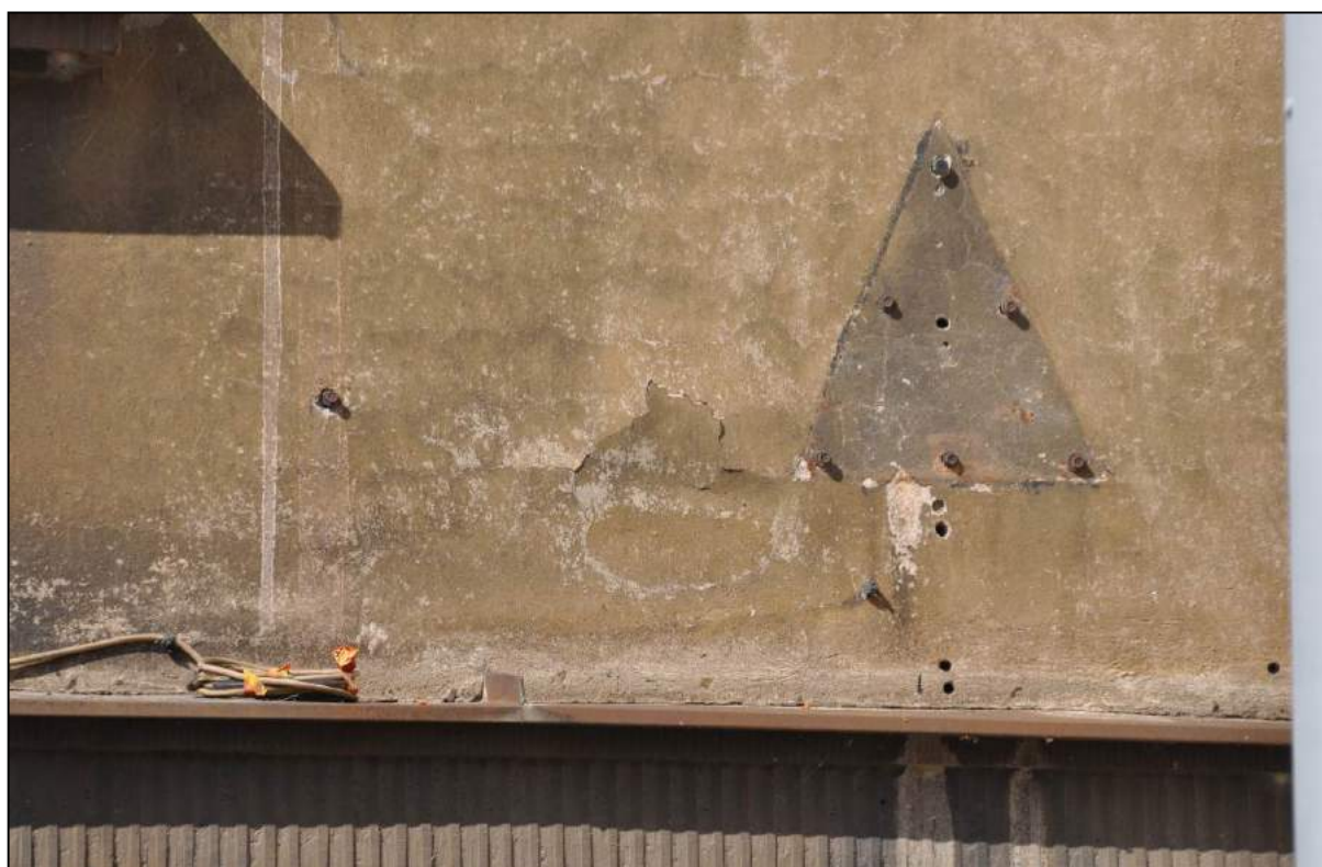
Fot. 8 Kamienica przy ul. Krakowskiej 49, fasada, kondygnacja 1 pietra, na prawo od osi 5. Tynki nad gzymsem kordonowym - odspojenia, spęcherzenia tynku. Wrzesień 2022r. M. Wida
