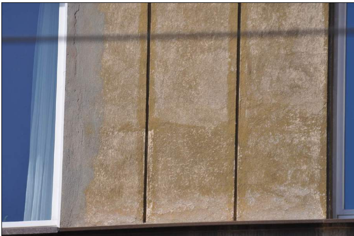
Fot. 7 Kamienica przy ul. Krakowskiej 49, fasada, kondygnacja 2 pietra, tynki między osią 2 i 3. Przetarte warstwy farb odsłaniają tynk z ziarnem miki.. Nad ofasowaniem gzymsu odspojone tynki. Wrzesień 2022r. M. Wida
