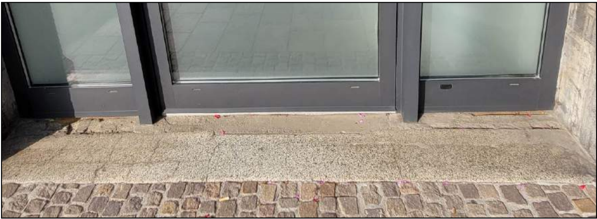
próg w wejściu do gabinetu stomatologicznego, spękany z ubytkami wypełnionymi cementem
