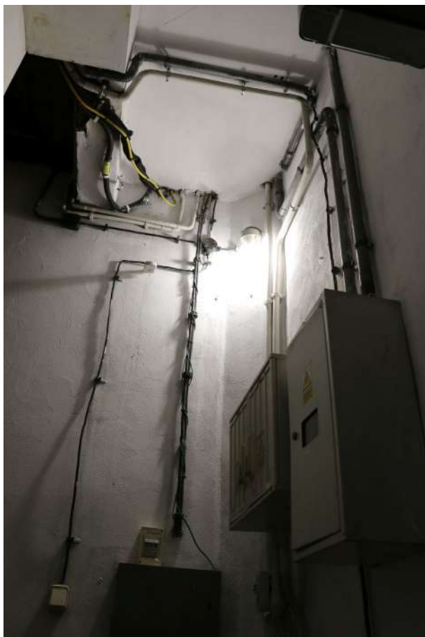
fot. 36: Wnętrze wieży - widoczna instalacja elektryczna oraz skrzynki rozdzielcze.
