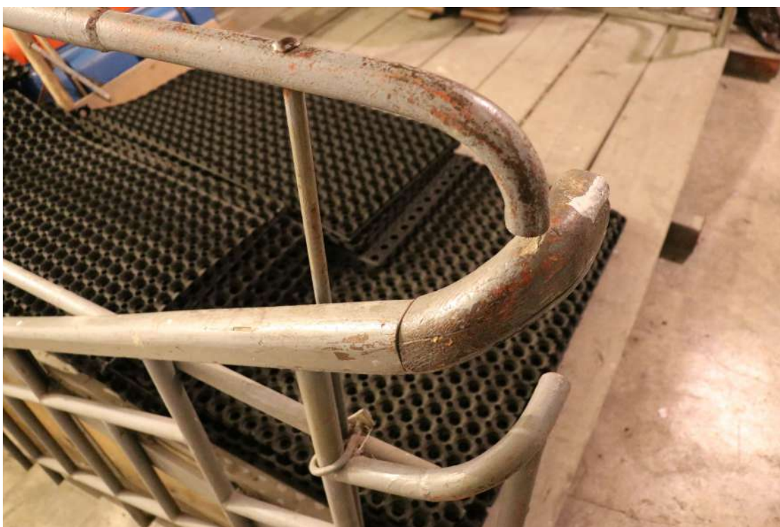
fot. 44: Wnętrze wieży - widoczny fragment metalowej balustrady u drewniany pochwyty z uszkodzeniami.
