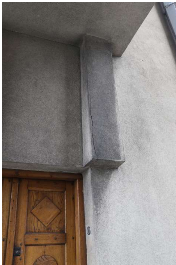
fot. 22: Elewacja wschodnia - widoczne pęknięcia tynku.
