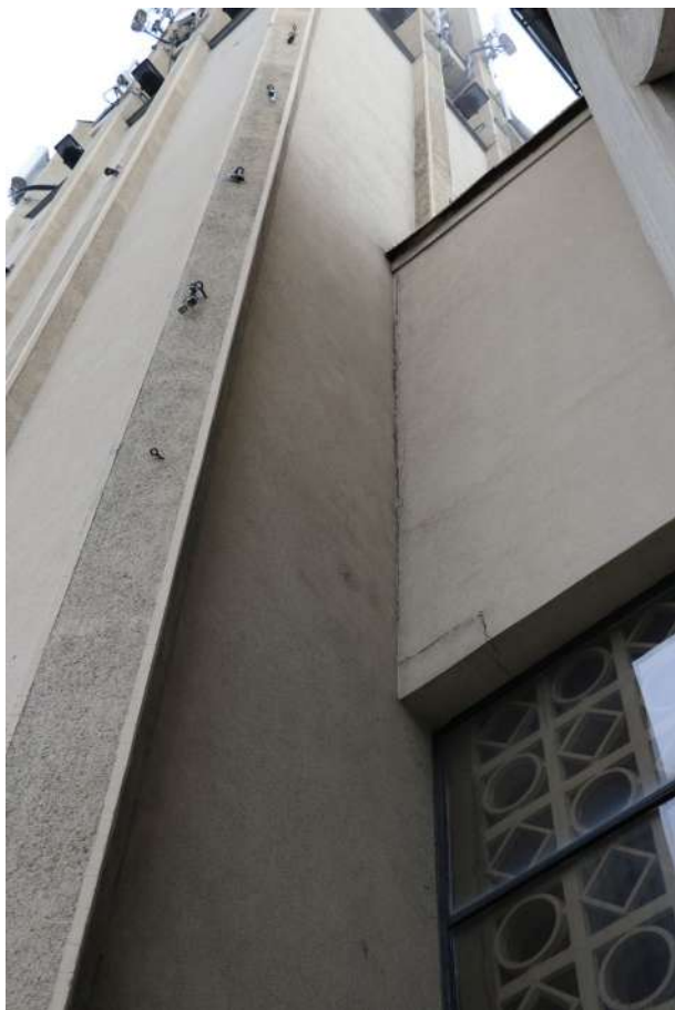
fot. 18: Elewacja wschodnia - widoczne pęknięcie na łączeniu wieży z przewiązką kościoła.
