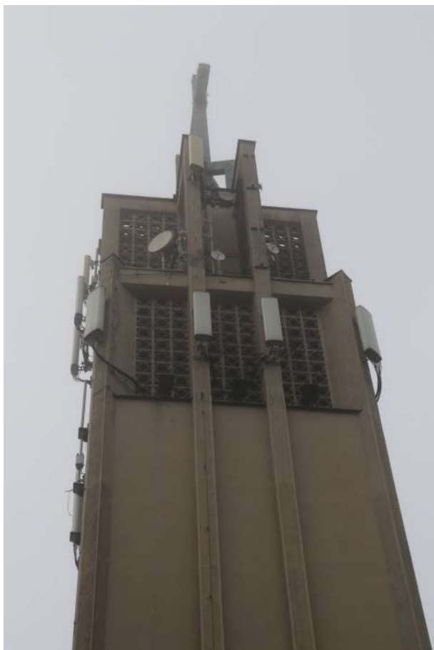
fot. 9: Elewacja północna - widok ostatnich kondygnacji wraz z urządzeniami sieci GSM.
