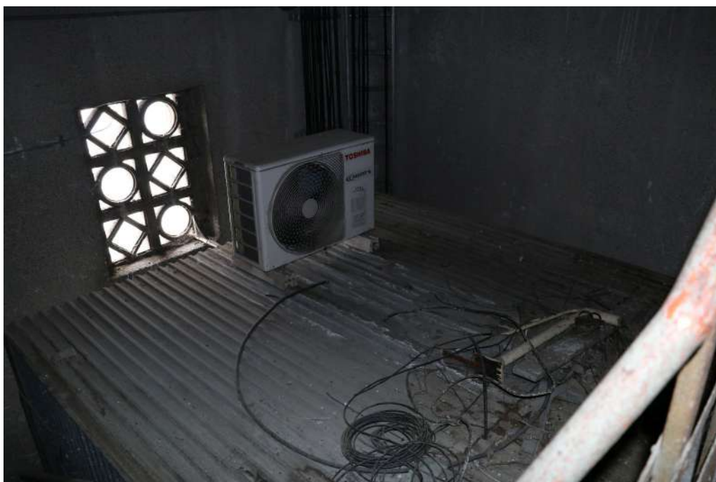
fot. 49: Wnętrze wieży - widoczny klimatyzator oraz nieuporządkowane okablowanie.
