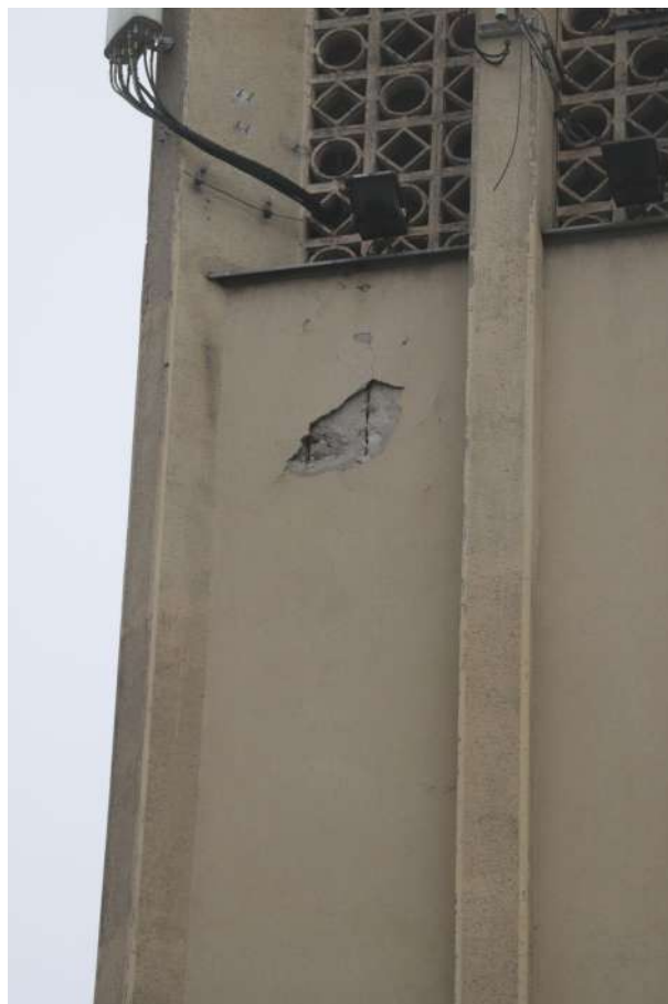
fot. 3: Elewacja południowa - uszkodzenie tynku wierzchniego, otuliny oraz odsłonięte zbrojenie.
