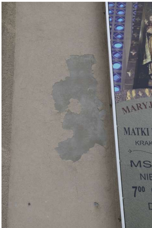
fot. 5: Elewacja południowa - widoczne uszkodzenia warstwy tynku cementowego.
