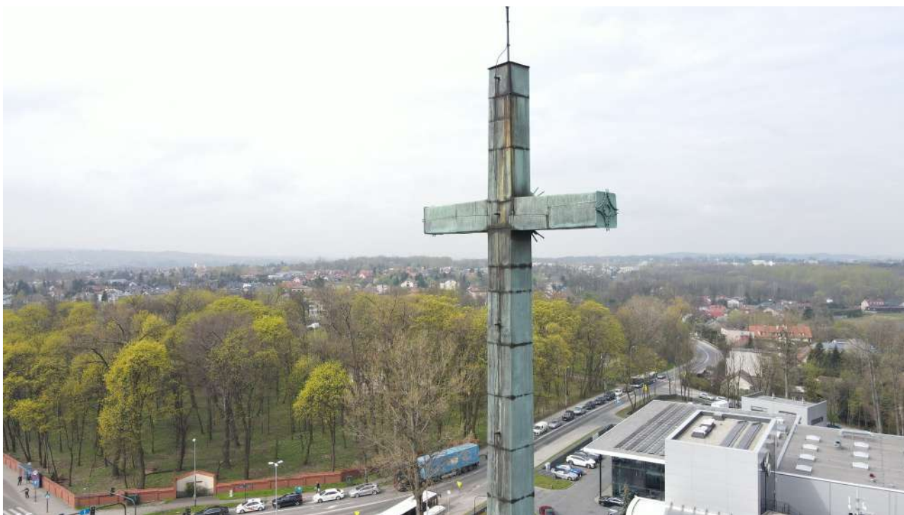
fot. 29: Krzyż wieży - widoczne zacieki na powierzchni blachy miedzianej oraz uszkodzenia na łączeniu arkuszy blachy.
