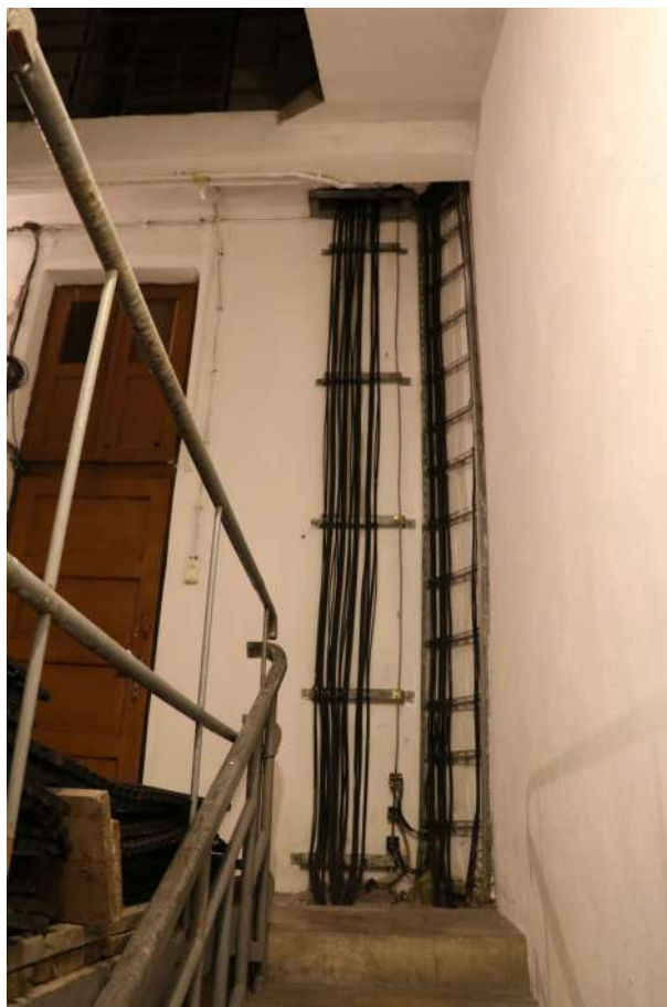
fot. 37: Wnętrze wieży - widoczne wiązki kabli poprowadzone w kanałach technicznych.
