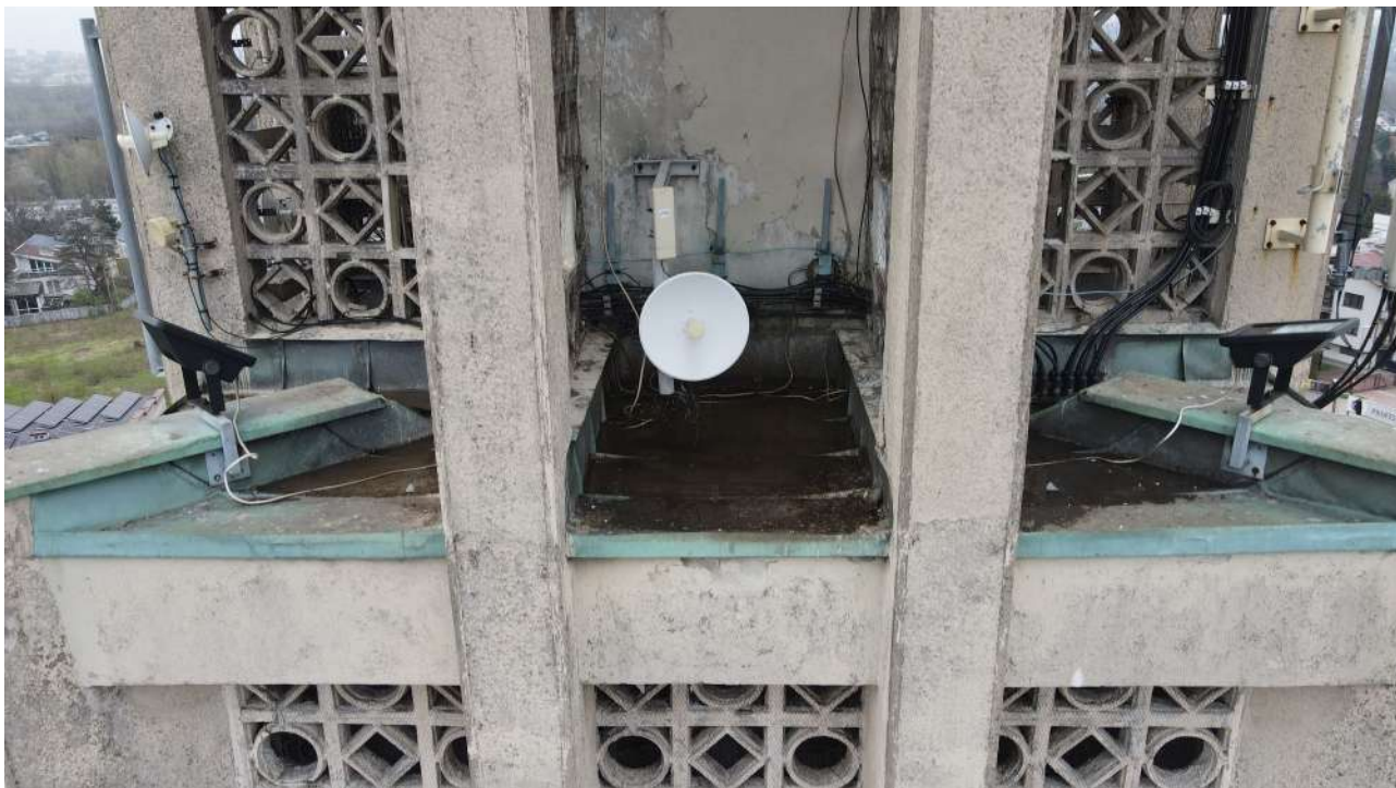
fot. 32: Okładzina stropodachu wykonana z blachy miedzianej - widoczna zalegająca woda oraz ptasie odchody.
