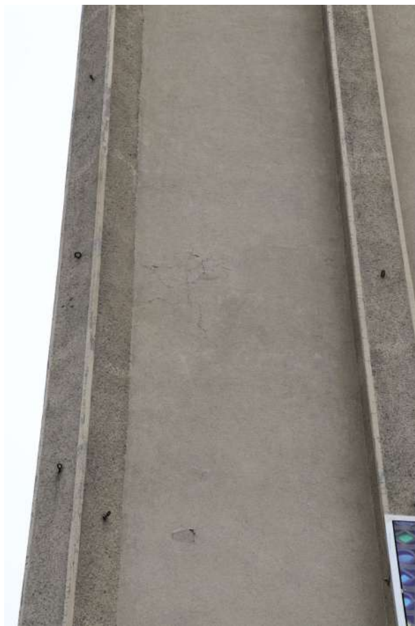
fot. 6: Elewacja południowa - widoczne spękania pajęczynkowe tynku cementowego.
