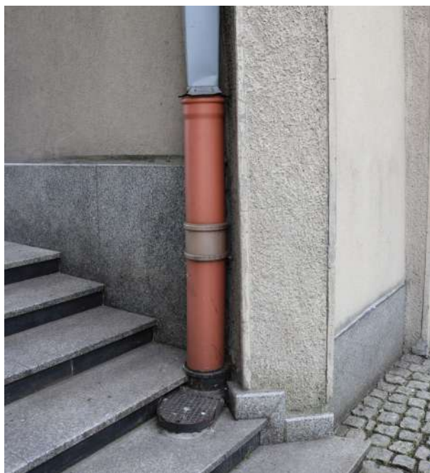
fot. 20: Elewacja wschodnia - widoczny fragment dolnej części rury spustowej wykonany z PCV.
