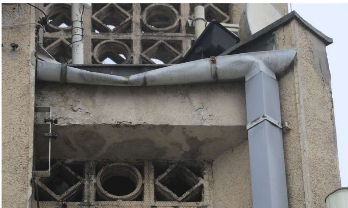
fot. 15: Elewacja wschodnia - widoczne uszkodzenie rynny oraz tynku elewacyjnego.
