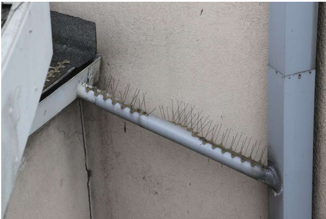
fot. 16: Elewacja wschodnia - widoczne uszkodzenia ekopików na rynnie odprowadzającej.
