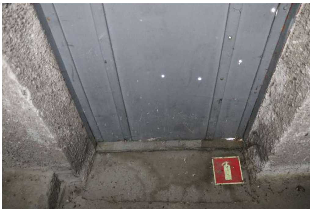
fot. 47: Wnętrze wieży - fragment metalowych drzwi wyjściowych na dach.
