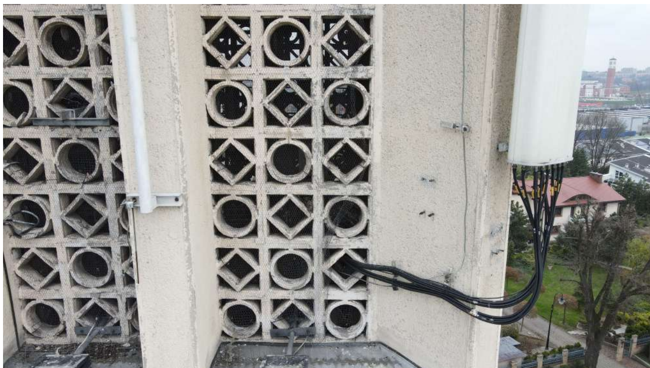
fot. 34: Prefabrykowane kształtki osłonięte plecioną siatką z uszkodzeniami.
