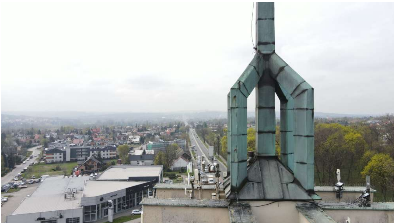
fot. 28: Fragment krzyża - widoczna miedziana okładzina z uszkodzeniami na łączeniach arkuszy blachy.
