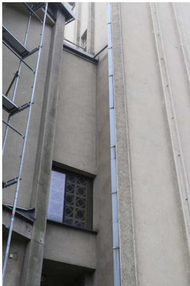
fot. 19: Elewacja wschodnia - widoczne pęknięcie na łączeniu wieży z przewiązką kościoła.
