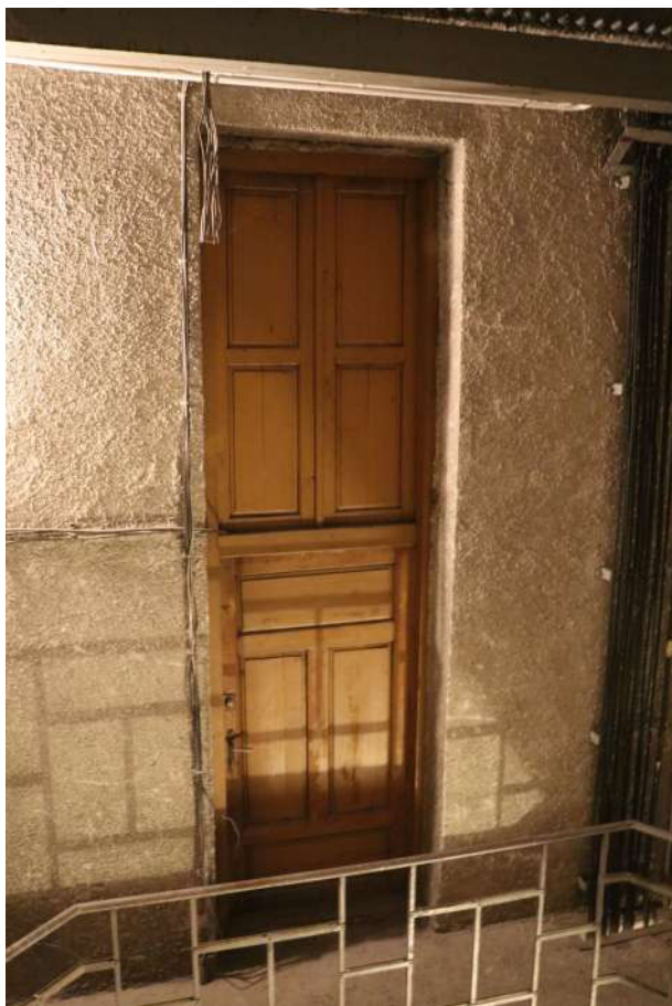
fot. 45: Wnętrze wieży - widoczna drewniana stolarka drzwiowa przeznaczona do wymiany.
