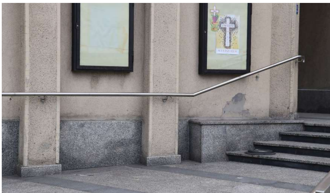
fot. 7: Elewacja południowa - widoczne uszkodzenia tynku cementowego nad cokolem.
