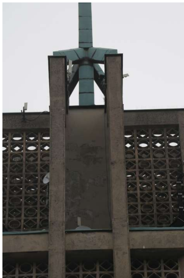
fot. 26: Elewacja zachodnia - widoczne uszkodzenia tynku elewacyjnego.
