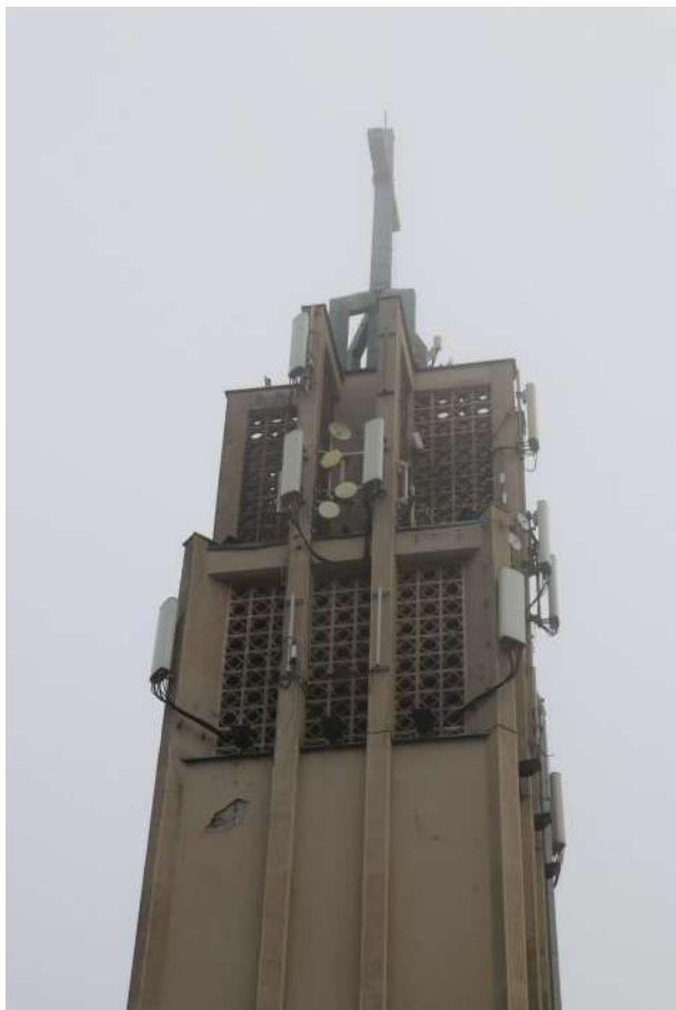
fot. 2: Elewacja południowa - widoczne ostatnie kondygnacje wraz z urządzeniami sieci GSM.
