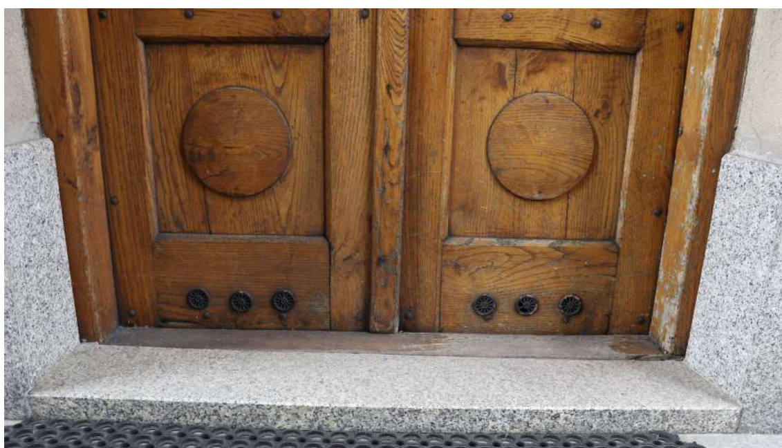
fot. 23: Elewacja wschodnia - widoczne uszkodzenia dolnych partii drzwi.
