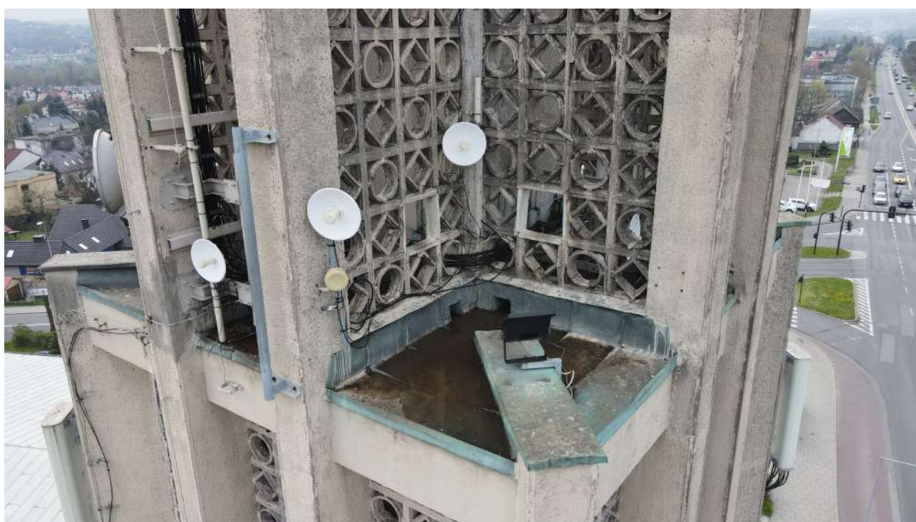
fot. 31: Okładzina stropodachu wykonana z blachy miedzianej - widoczna zalegająca woda oraz ptasie odchody.
