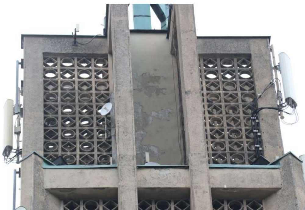
fot. 27: Elewacja zachodnia - widoczne urządzenia sieci GSM.
