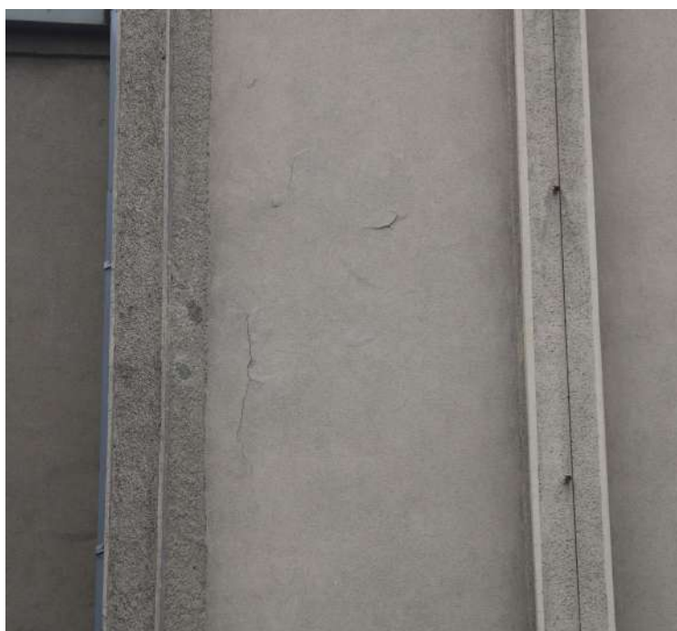
fot. 11: Elewacja północna - widoczne spękania pajączkowe.
