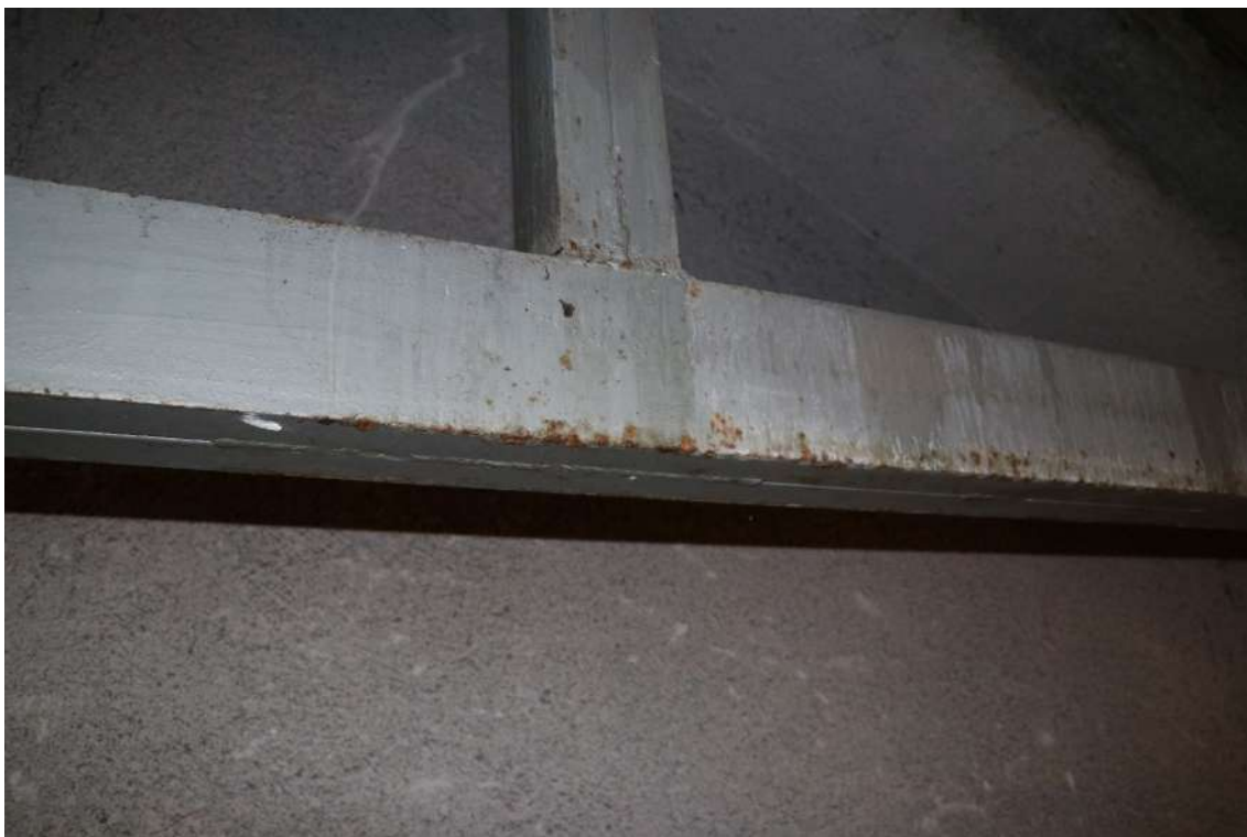
fot. 39: Wnętrze wieży - widoczne ogniska korozji na stalowych belka wsporczych.
