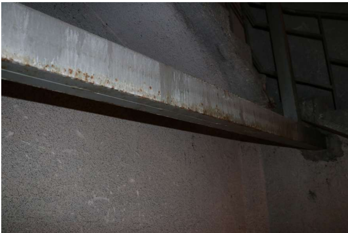
fot. 40: Wnętrze wieży - widoczne ogniska korozji na belkach wsporczych.
