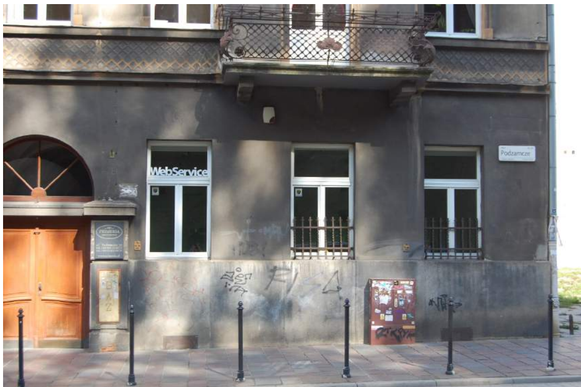
Widok ogólny elewacji. Widoczne zabrudzenie całej powierzchni, miejscowe wycięcie powierzchni tynków przez spływającą wodę
