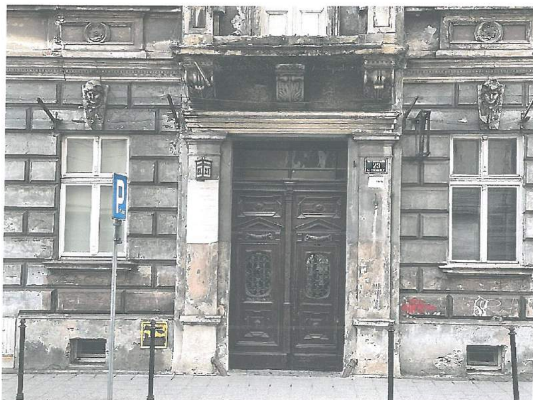
Fot.14. Kraków, ul. Starowiślna 23 – elewacja frontowa – stan zachowania. Widoczne zabrudzenia i ubytki tynku. Fot. M. Ratajczyk 28.04.2022
