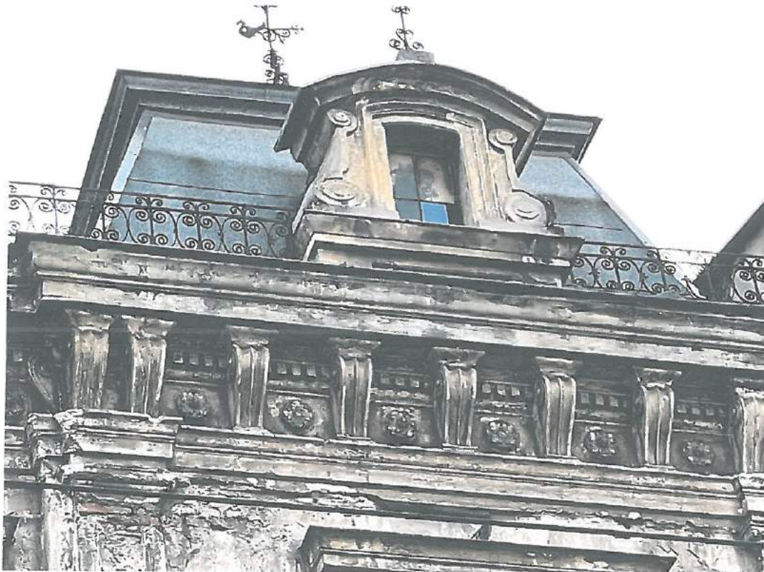
Fot.6. Kraków, ul. Starowiślna 23 – elewacja frontowa, lukarna prawa – stan zachowania. Widoczne ubytki i złuszczenia tynku. Fot. M. Ratajczyk 28.04.2022
