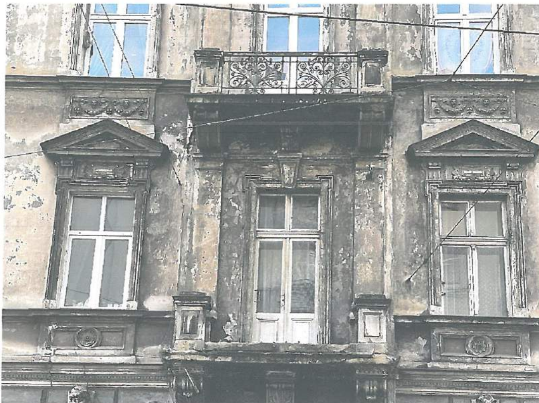
Fot.13. Kraków, ul. Starowiślna 23 – elewacja frontowa – stan zachowania. Widoczny brak balustrady balkonu. Fot. M. Ratajczyk 28.04.2022
