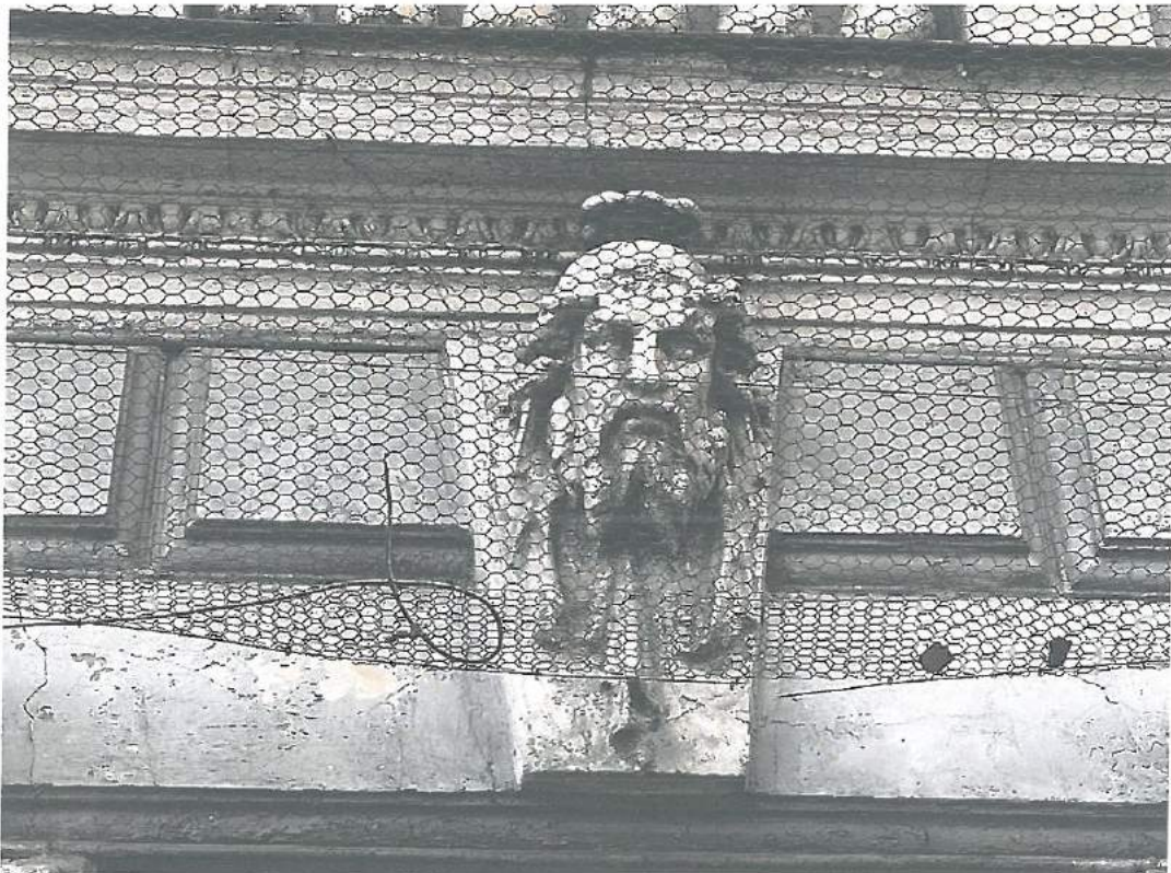
Fot.20. Kraków, ul. Starowiślna 23 – elewacja frontowa – stan zachowania. Widoczne pęknięcie gzymsu kordonowego. Fot. M. Ratajczyk 28.04.2022
