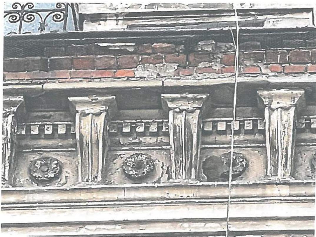
Fot.10. Kraków, ul. Starowiślna 23 – elewacja frontowa – stan zachowania. Widoczny całkowity ubytek tynku w miejscu profilowania gzymsu wieńczącego. Fot. M. Ratajczyk 28.04.2022
