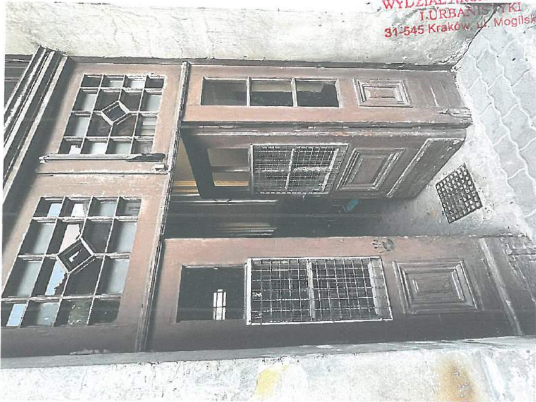
Fot.33. Kraków, ul. Starowiślna 23 – elewacja tylna, brama podwórzowa – stan zachowania. Fot. M. Ratajczyk 28.04.2022
