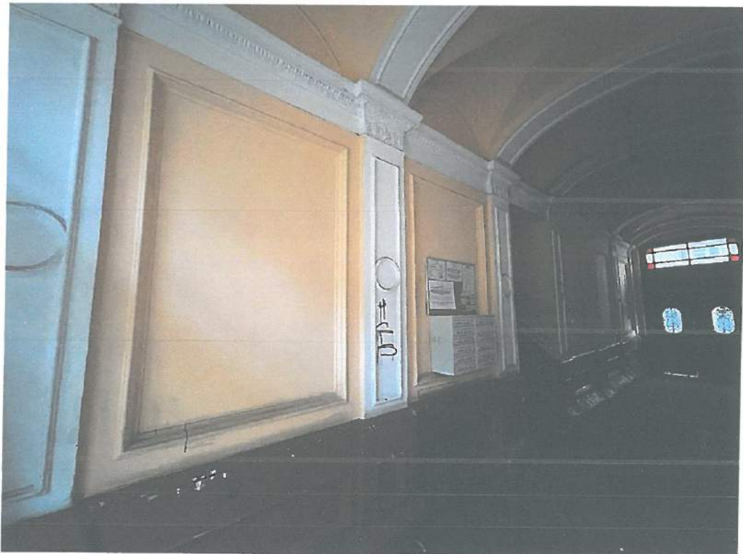
Fot.38. Kraków, ul. Starowiślna 23 – sień, widok w kierunku. ptn.-wsch. – stan zachowania. Fot. M. Ratajczyk 28.04.2022
