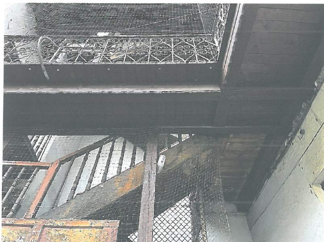
Fot.30. Kraków, ul. Starowiślna 23 – elewacja tylna i oficyna, ganki i kuchenne schody – stan zachowania. Fot. M. Ratajczyk 28.04.2022
