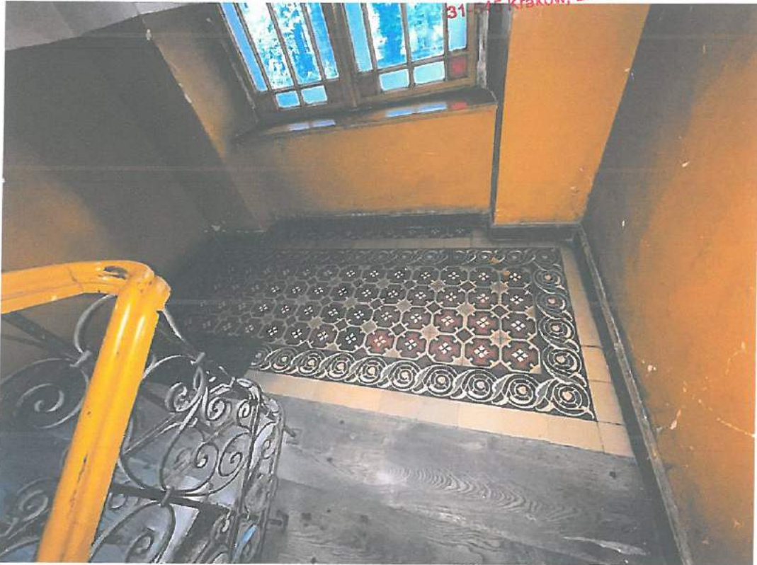
Fot.47. Kraków, ul. Starowiślna 23 – klatka schodowa, posadzka dywanowa na spoczniku półpiętra II – III p. – stan zachowania. Fot. M. Ratajczyk 28.04.2022
