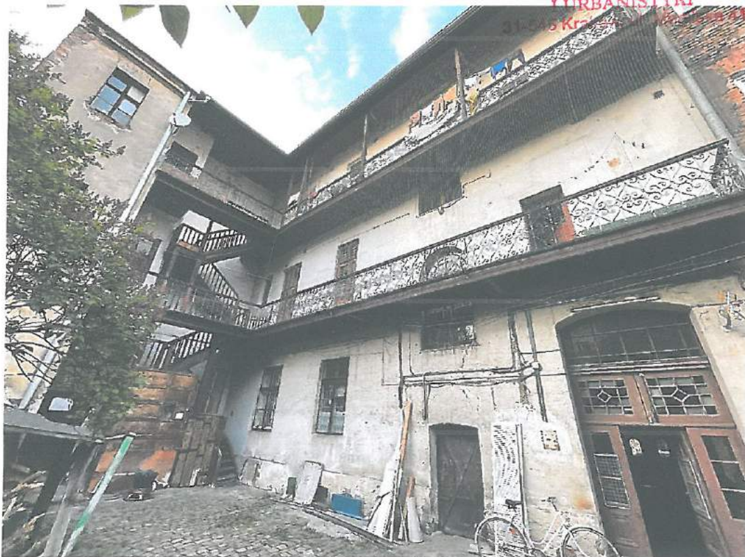
Fot.27. Kraków, ul. Starowiślna 23 – elewacja tylna i oficyna – stan zachowania. Fot. M. Ratajczyk 28.04.2022
