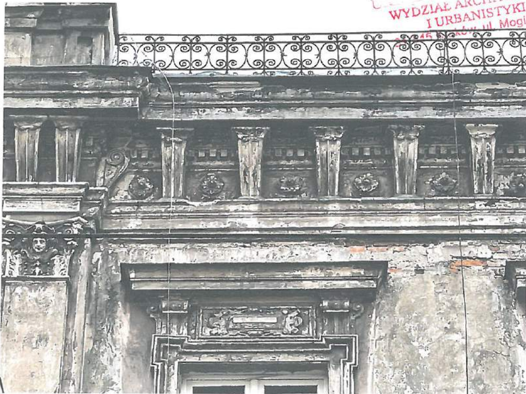
Fot.9. Kraków, ul. Starowiślna 23 – elewacja frontowa – stan zachowania. Widoczne ubytki i złuszczenia tynku. Fot. M. Ratajczyk 28.04.2022
