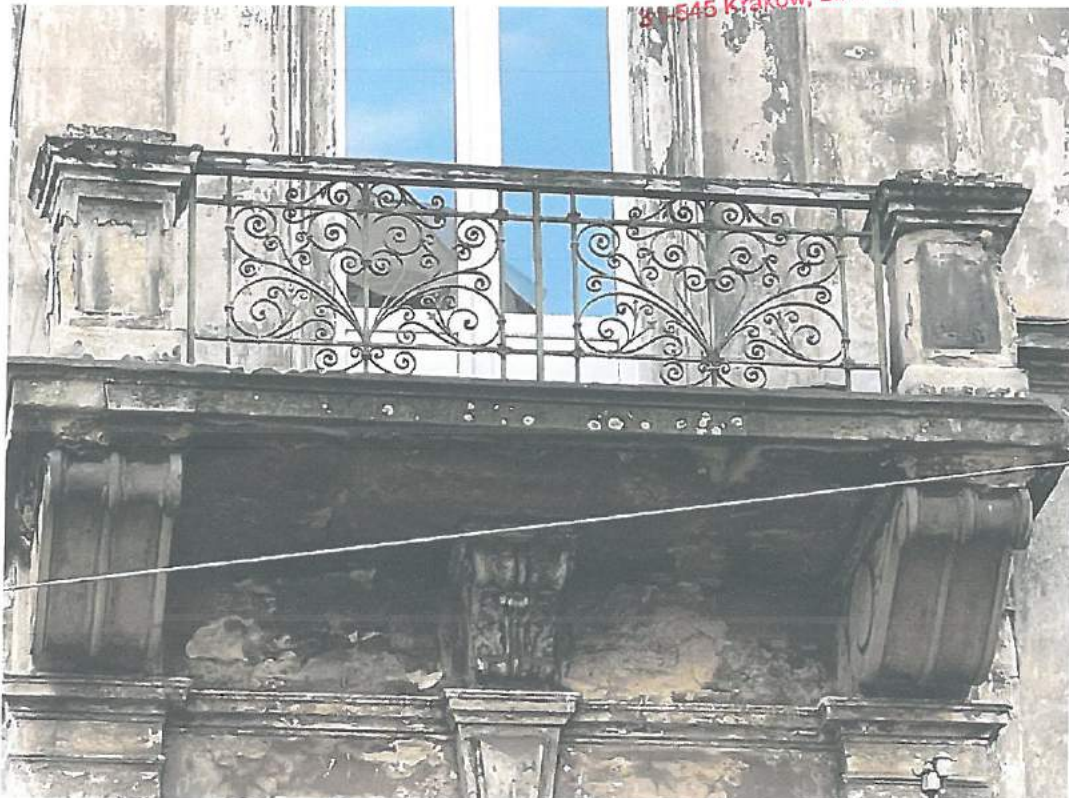
Fot.11. Kraków, ul. Starowiślna 23 – elewacja frontowa – stan zachowania. Widoczne ubytki i złuszczenia tynku. Fot. M. Ratajczyk 28.04.2022
