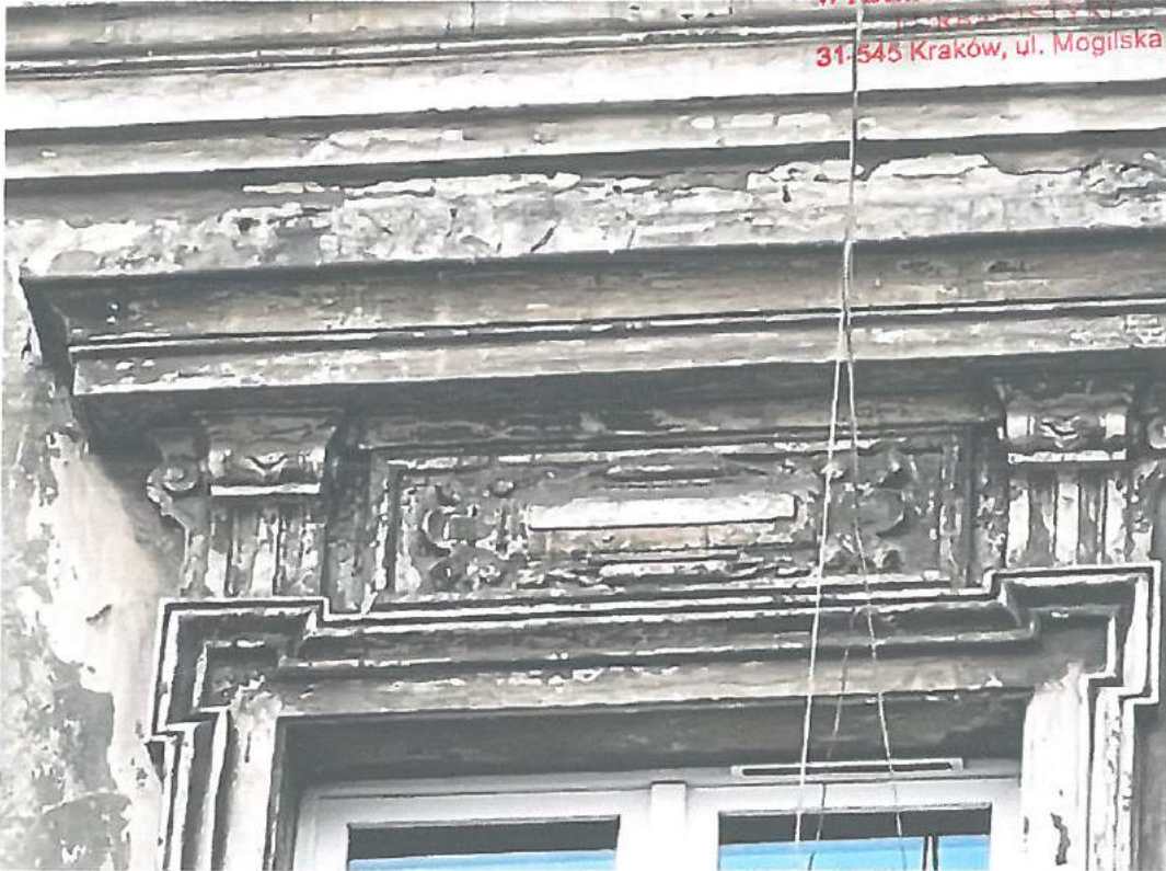
Fot.15. Kraków, ul. Starowiślna 23 – elewacja frontowa – stan zachowania. Widoczne ubytki nadokiennika. Fot. M. Ratajczyk 28.04.2022
