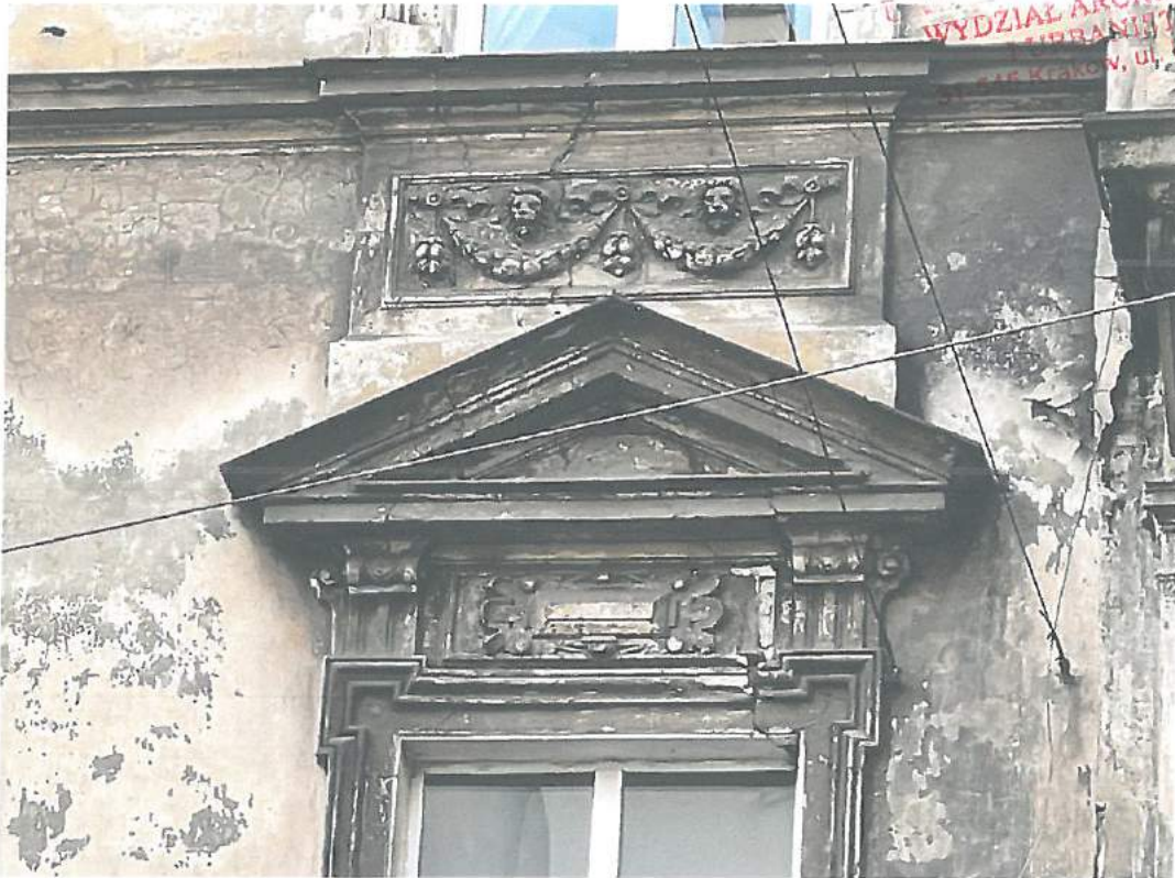
Fot.17. Kraków, ul. Starowiślna 23 – elewacja frontowa – stan zachowania. Widoczne pęknięcie nadproża. Fot. M. Ratajczyk 28.04.2022
