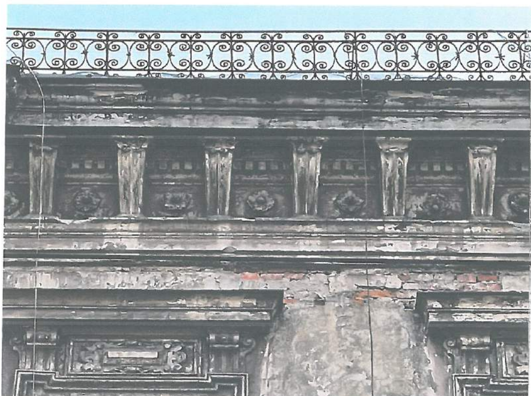
Fot.8. Kraków, ul. Starowiślna 23 – elewacja frontowa – stan zachowania. Widoczne ubytki i złuszczenia tynku. Fot. M. Ratajczyk 28.04.2022
