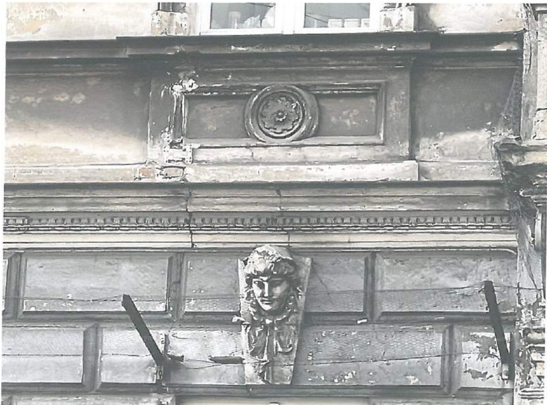
Fot.18. Kraków, ul. Starowiślna 23 – elewacja frontowa – stan zachowania. Widoczne pęknięcia gzymsu kordonowego. Fot. M. Ratajczyk 28.04.2022
