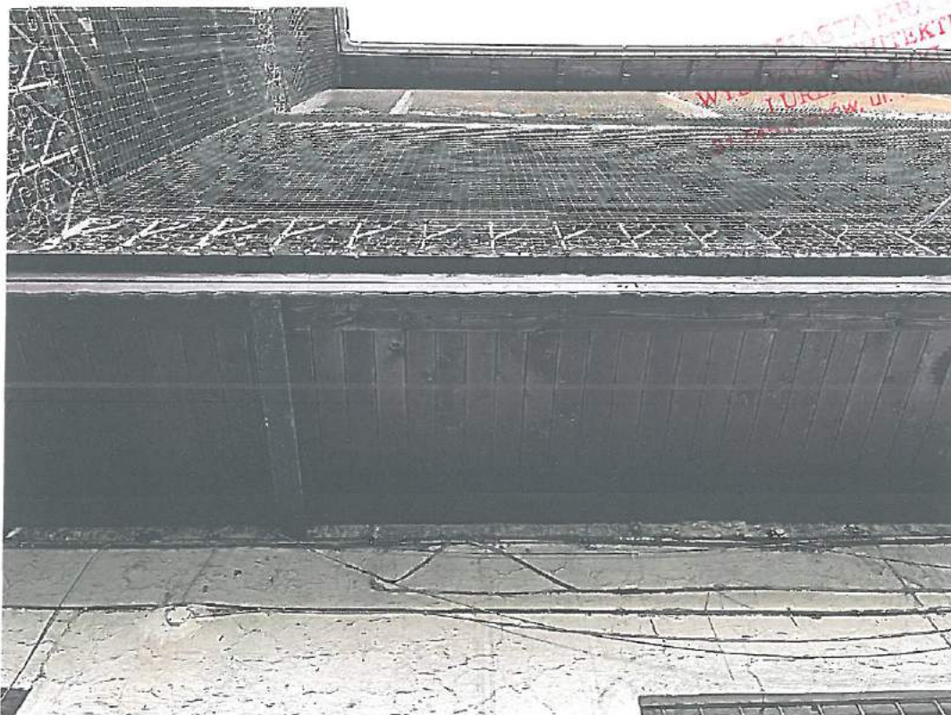
Fot.29. Kraków, ul. Starowiślna 23 – elewacja tylna, ganek – stan zachowania. Fot. M. Ratajczyk 28.04.2022
