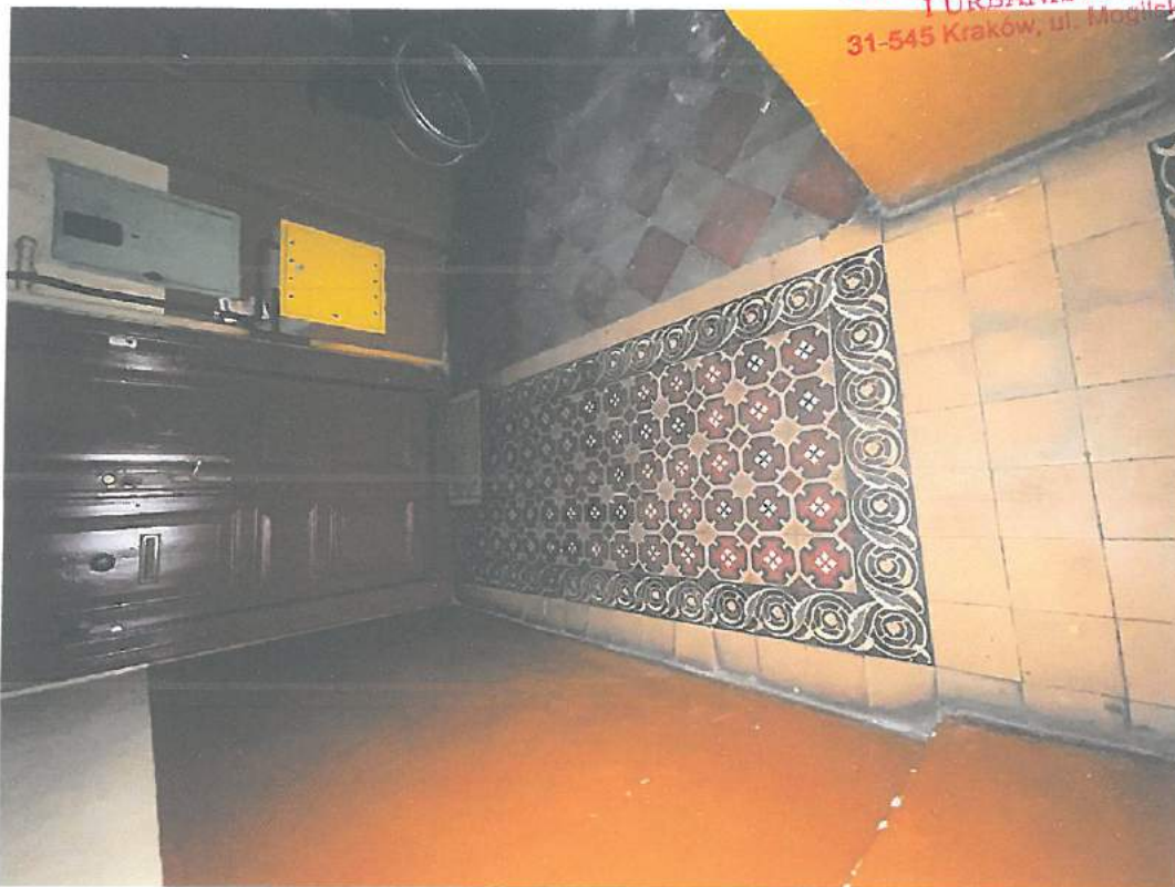
Fot.43. Kraków, ul. Starowiślna 23 – klatka schodowa, posadzka dywanowa na II p. – stan zachowania. Fot. M. Ratajczyk 28.04.2022
