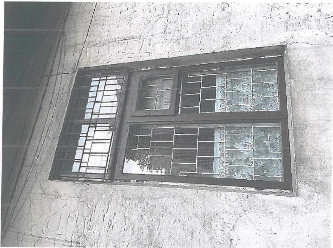
Fot.34. Kraków, ul. Starowiślna 23 – elewacja tylna, stolarka okienna parteru – stan zachowania. Fot. M. Ratajczyk 28.04.2022
