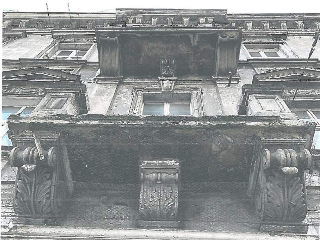
Fot.22. Kraków, ul. Starowiślna 23 – elewacja frontowa – stan zachowania. Widoczne złuszczenia kamiennych płyt balkonów. Fot. M. Ratajczyk 28.04.2022
