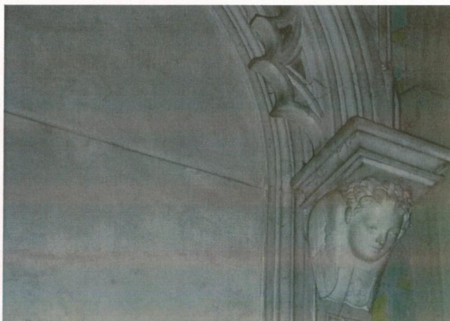
Nagrobek Anny Rózyckiej. Fragment. Północne ramie transeptu. Ściana wschodnia. Widoczne zabrudzenia powierzchni .
