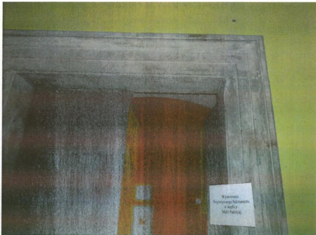
Portal prowadzący do kaplicy Męki Pańskiej, nawa główna, ściana północna, pod chórem, fragment. Widoczna zabrudzona, wyplamiona powierzchnia.
