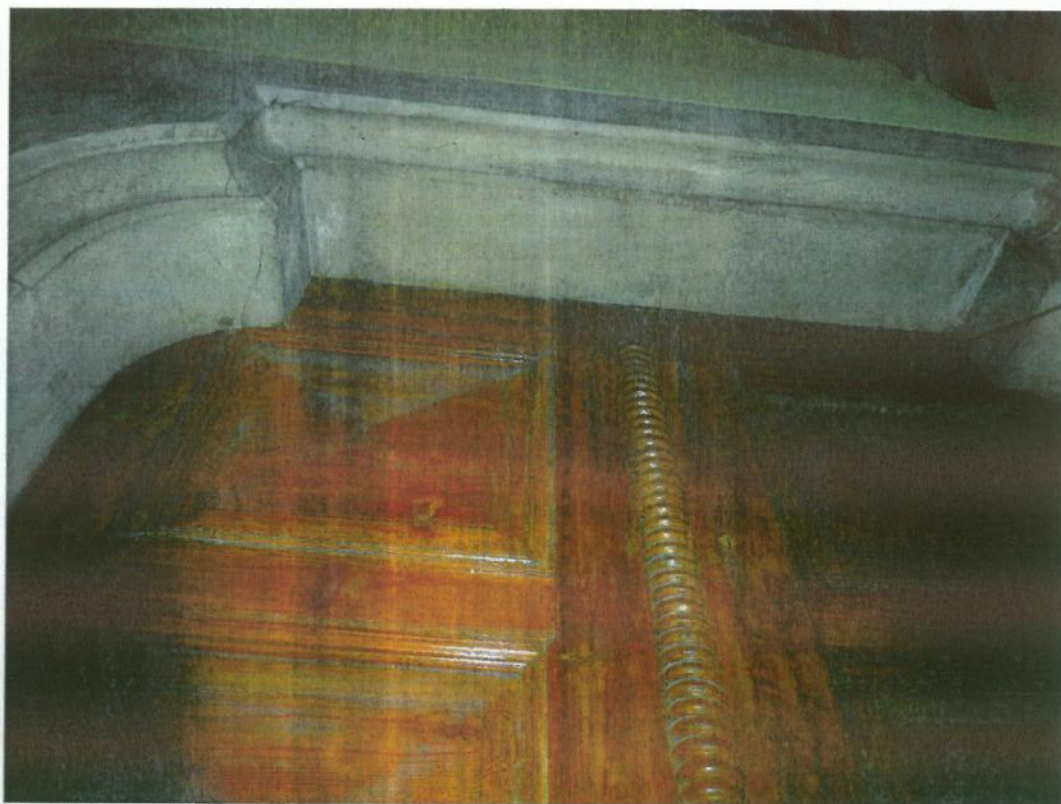
Portal prowadzący do zachodniego skrzydła klasztoru z nawy w przestrzeni pod chórem, fragment nadproża, Widoczne pociemniałe kity i uzupełnienia miejscami spękane.
