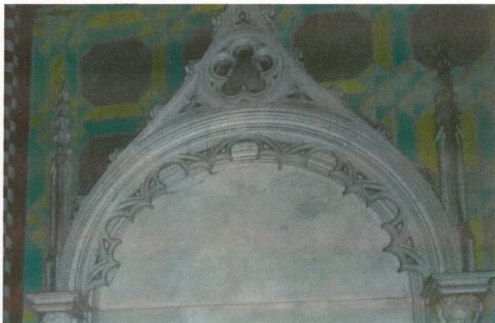
Nagrobek Anny Rózyckiej. Fragment. Północne ramie transeptu. Ściana wschodnia. Widoczne zabrudzenia powierzchni .
