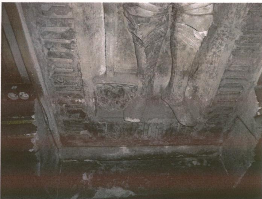
Kraków. Kościół p.w. św. Franciszka z Asyżu. Prezbiterium strona północna A. Płyta nagrobna nieznanego księcia Władysława /zm.1270/. Dolny fragment. Widoczne zabrudzenia oraz ubytki mechaniczne.
