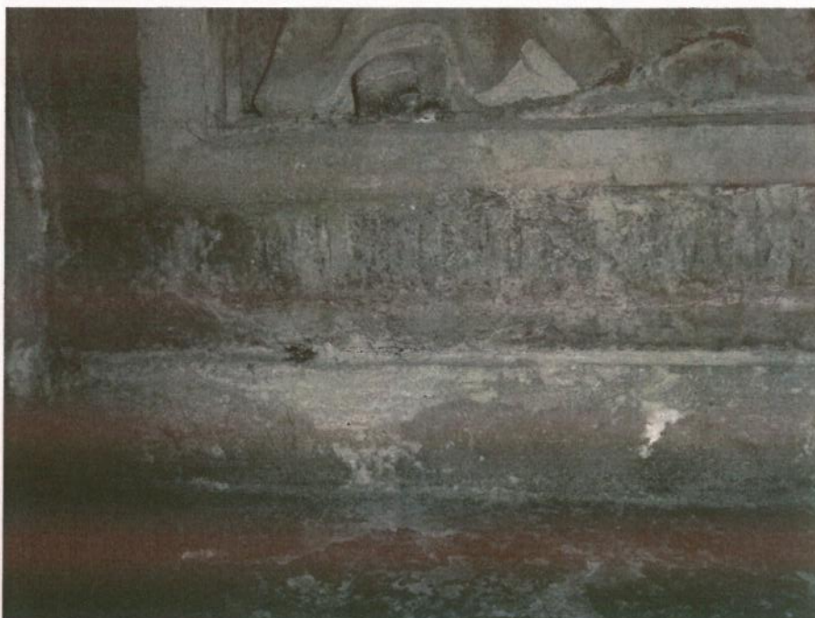
Kraków. Kościół p.w. św. Franciszka z Asyżu. Prezbiterium strona południowa B. Płyta nagrobna zakonnika franciszkańskiego Marcina z Krakowa /zm.1494/. Dolny fragment. Widoczne zabrudzenia, pozostałości warstwy farby oraz ubytki mechaniczne.
