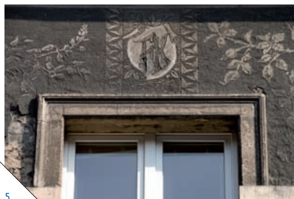
4. Niszczące sgraffita na szczycie fasady kamienicy przy ul. Konarskiego 17.
